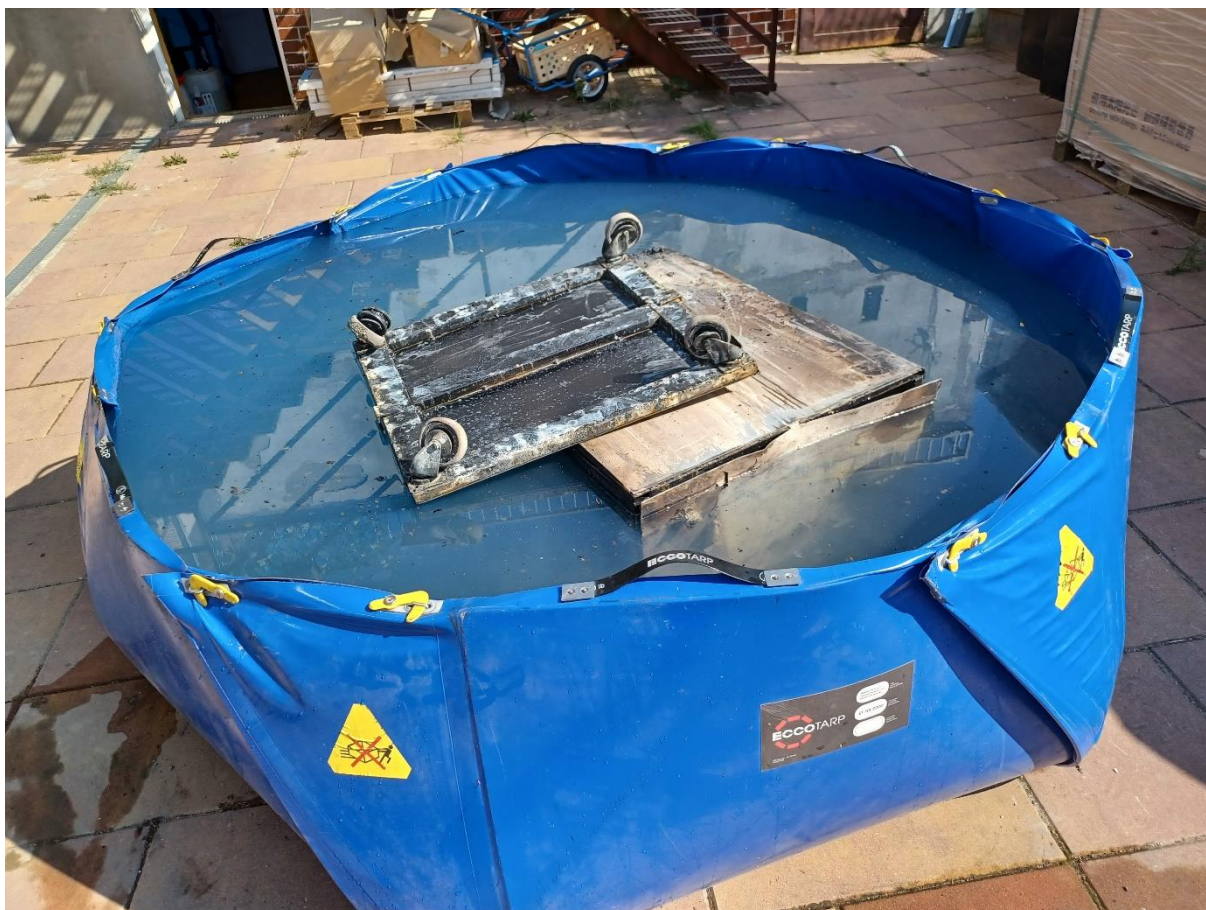
Obr. 40: bateriové uložení po požáru – zalité vodou
