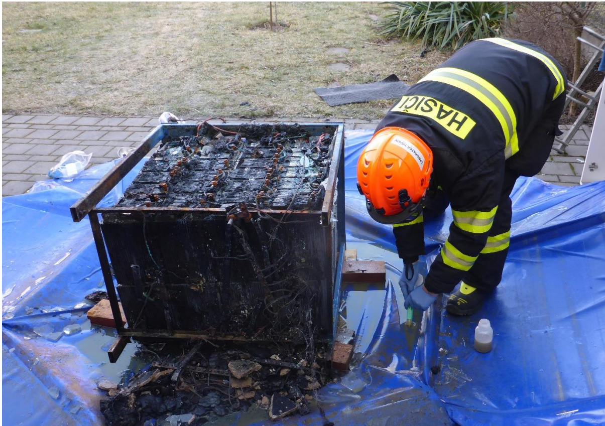
Obr. 39: konstrukce akumulčního bateriového uložistě po požáru
