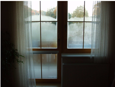
Obr. 1.1 Kondenzace vlhkosti na izolačním skle [18]
