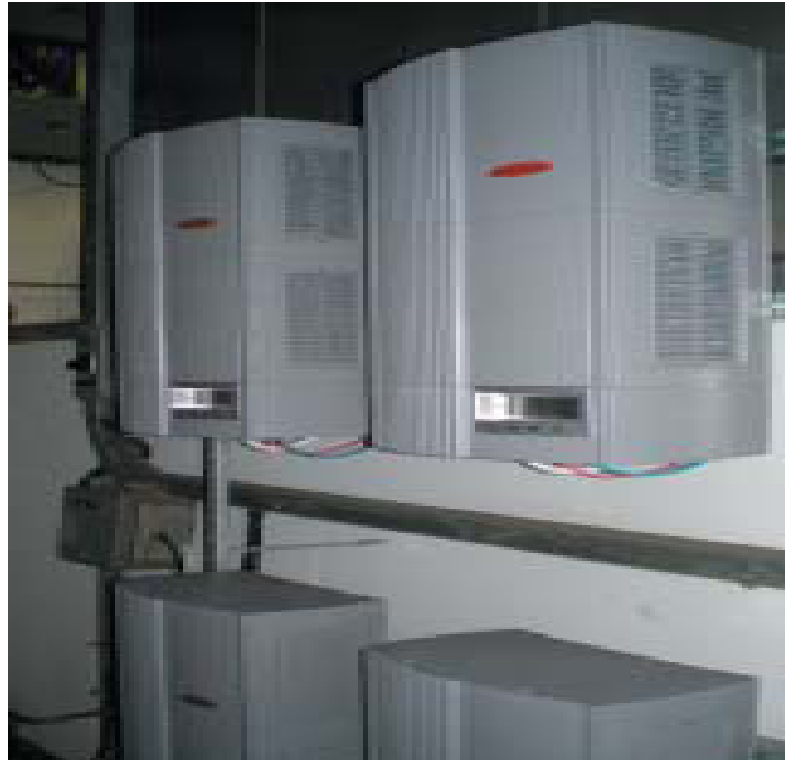
obr. 18 Umístění DC/AC-střídačů v interiéru
