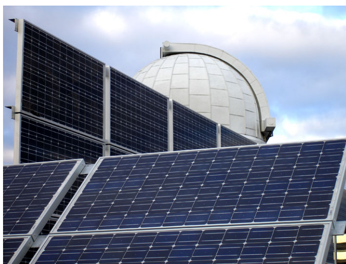
obr. 11 Dvě polohy FV panelů na ploché střeše
