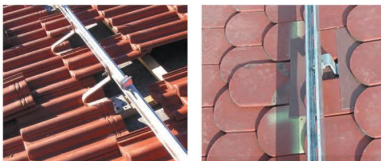
Obr. 11: Střešní háky a kolejnicový systém [34]
