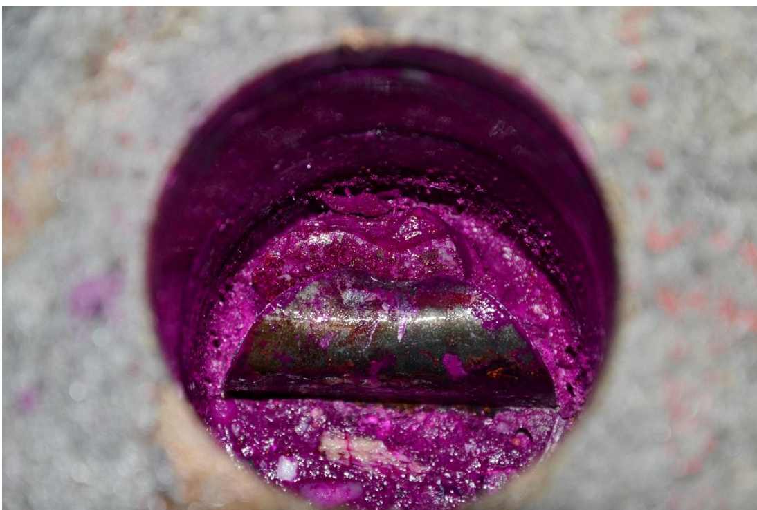
Obrázek 8.17 Sonda V11, pod kabelovou chráničkou je patrná zatvrdlá injektážní směs.
