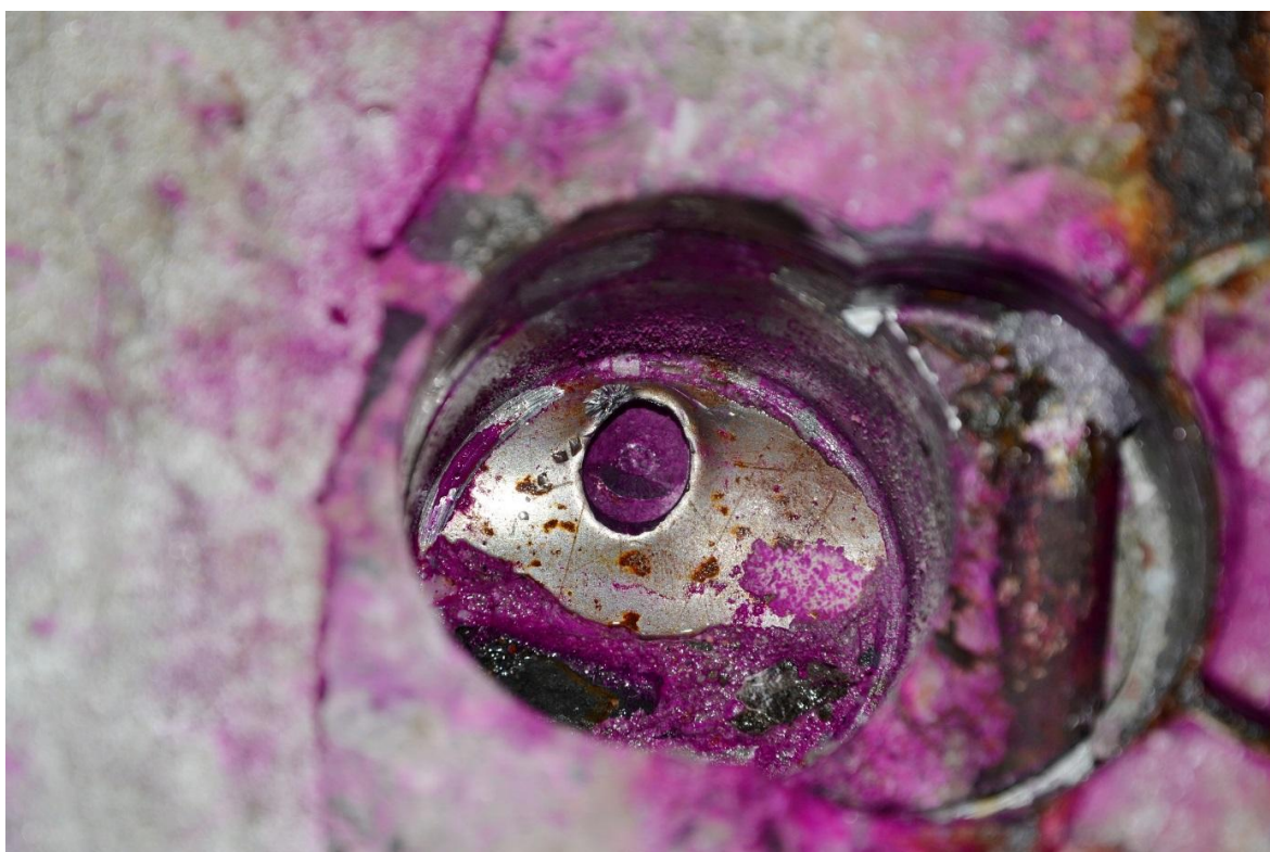
Obrázek 8.7 Sonda Z11 - patrný průřez chráničkou kabelového kanálku, viditelná injektážní směs
