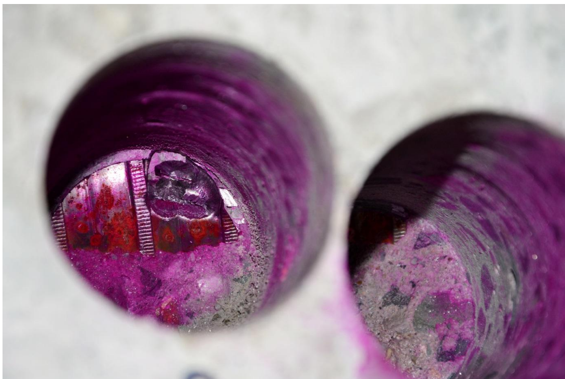
Obrázek 8.9 Sonda Z21 s patrným průrazem chráničkou kabelového kanálku a viditelnou injektážní směsí
