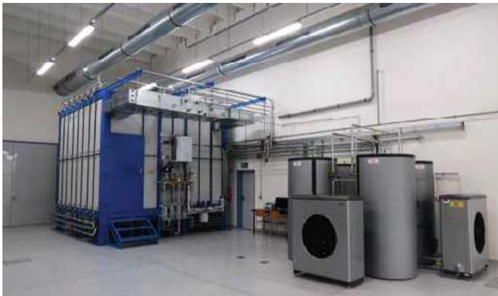
Obr. 6.2 Kalibrační komora v prostorách budovy NETME Centre
