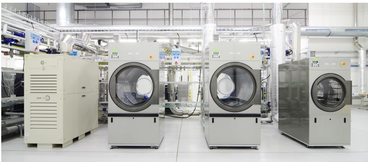
obr. 12: Plynová mikroturbína (zcela vlevo) a sestava bubnových sušičů (zleva: COD1 až COD3)
