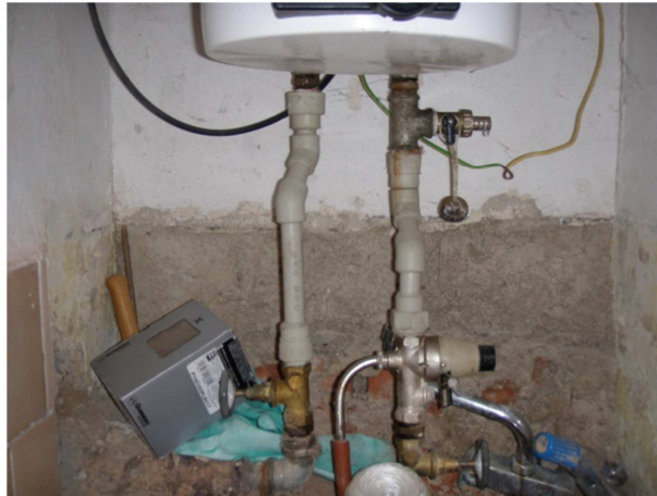
Obr. 3.6 Rozvody teplé vody
