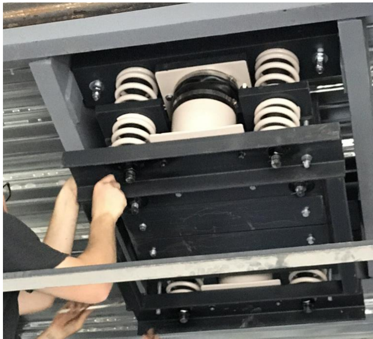
Obrázek 30: Instalace TMD v podlaze nemocnice. Převzato z [24]
