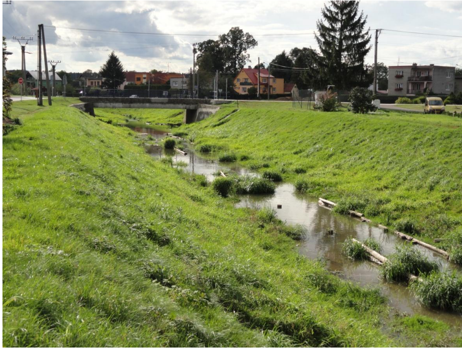
Obr. 6.12. Zanesené koryto pod mostem [21]
