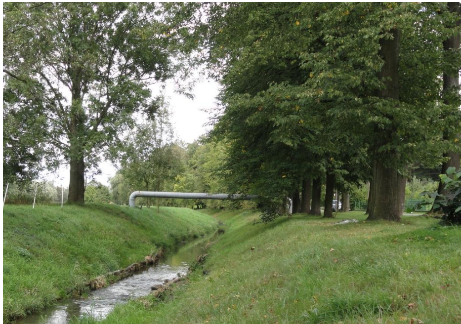
Obr. 6.14. Potrubní vedení, ř.km 1,065 [21]
