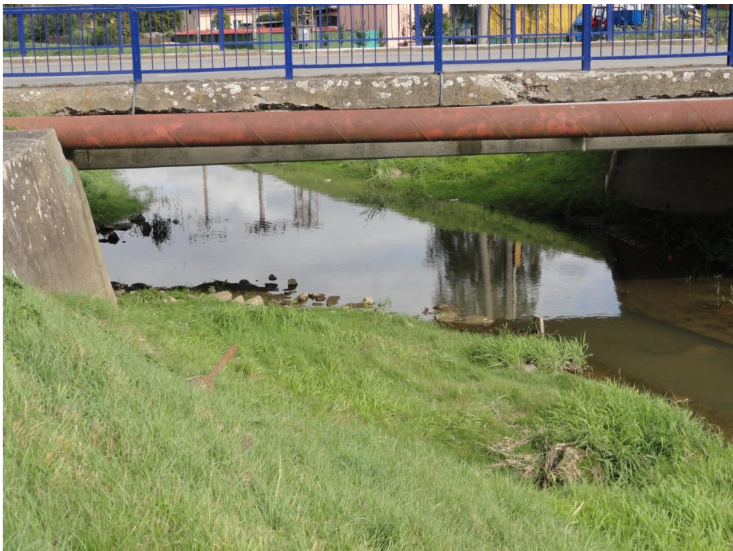
Obr. 6.11. Poškozené opevnění pod mostem ř.km 1,593 [21]
