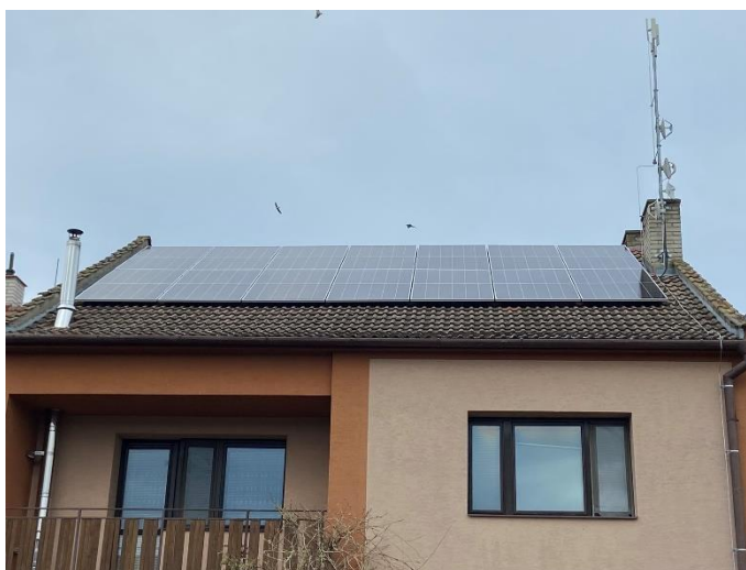
Obrázek 41: Střecha s fotovoltaickými panely
