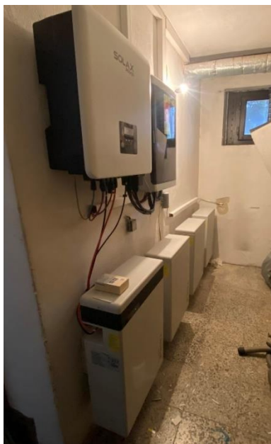
Obrázek 32: Technická místnost s instalovanou technologií
