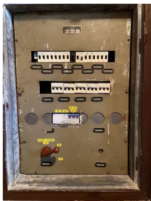
Obrázek 38: Zakrytý domovní rozvaděč RD
