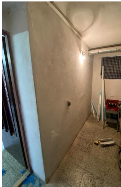
Obrázek 30: Technická místnost před instalací technologie
