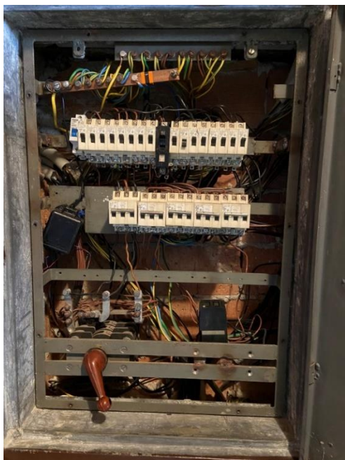
Obrázek 36: Domovní rozvaděč RD před doplněním technologie
