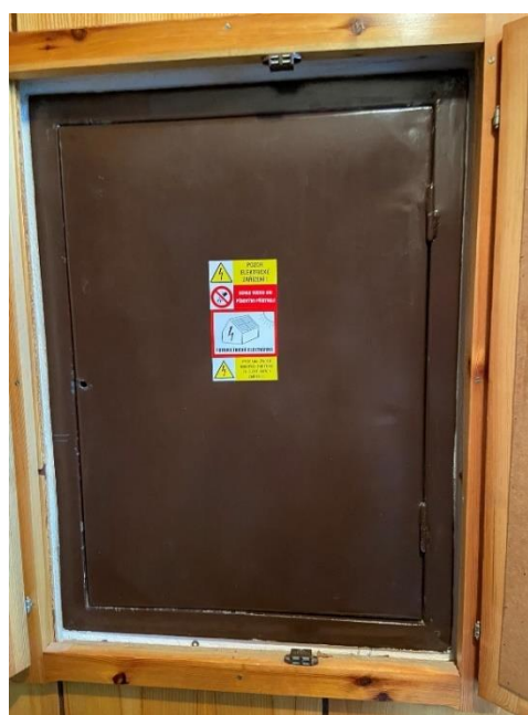
Obrázek 39: Domovní rozvaděč RD
