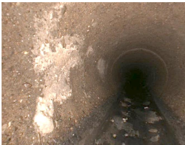
Obrázek 6-22 Ulpívající látky na potrubí v úseku 133-136 [zdroj: VaK Přerov]
