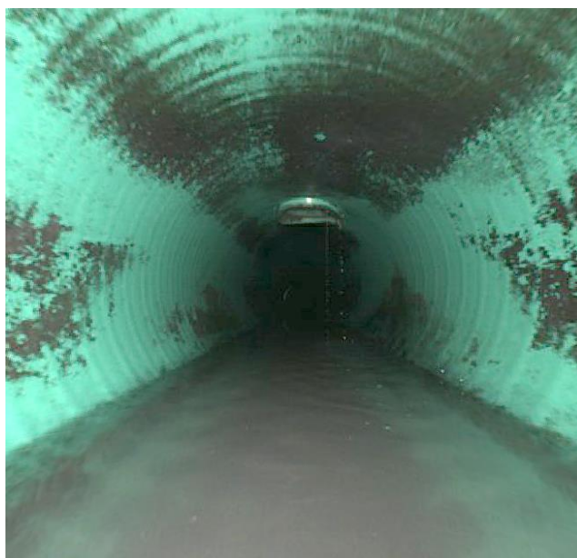
Obrázek 6-43 Přesazená přípojka na úseku Š37-Š38 [zdroj: VaK Přerov]
