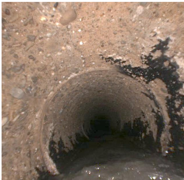
Obrázek 6-8 Prasklé potrubí na úseku 112-113 [zdroj: VaK Přerov]
