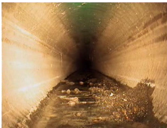
Obrázek 6-55 Usazeniny v potrubí Š45-Š44 [zdroj: Čagášek]
