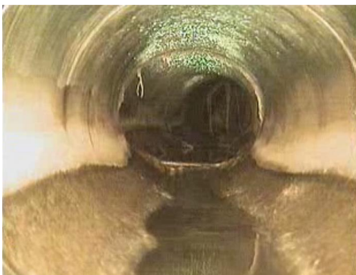
Obrázek 6-45 Deformace potrubí Š39-Š40 [zdroj: Čagášek]
