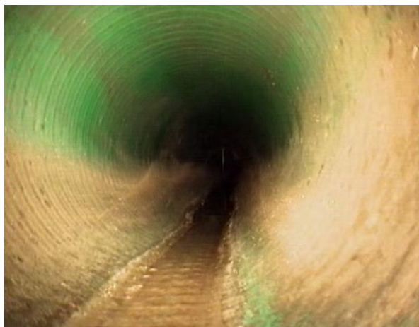
Obrázek 6-53 Mech. opotřebení potrubí Š44-Š43 [zdroj: Čagášek]
