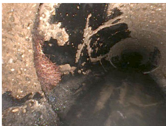
Obrázek 6-32 Prorůstající kořeny na úseku Š34-Š35 [zdroj: VaK Přerov]
