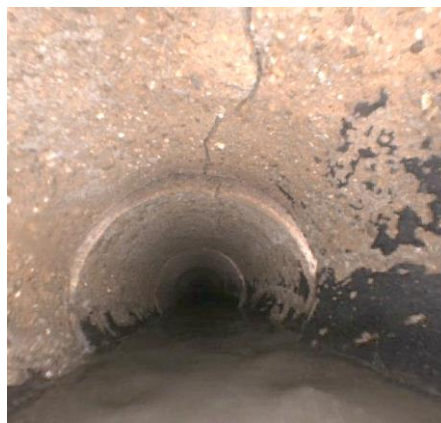
Obrázek 6-9 Deformované a prasklé potrubí na úseku 113-114 [zdroj: VaK Přerov]
