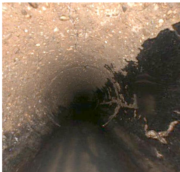
Obrázek 6-38 Prasklé potrubí na úseku Š33-Š34 [zdroj: VaK Přerov]
