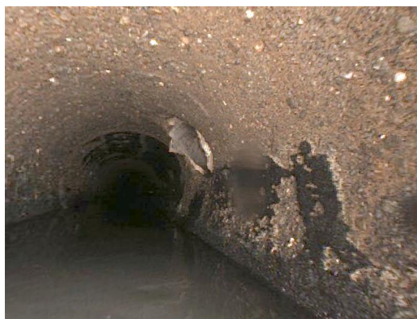
Obrázek 6-39 Přesazená přípojka na úseku Š33-Š34 [zdroj: VaK Přerov]
