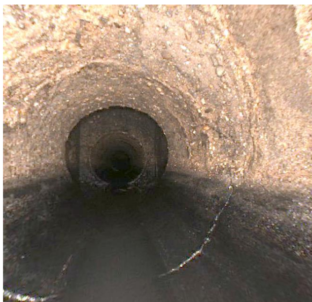
Obrázek 6-29 Prasklina po obvodu potrubí na úseku Š36-130 [zdroj: VaK Přerov]
