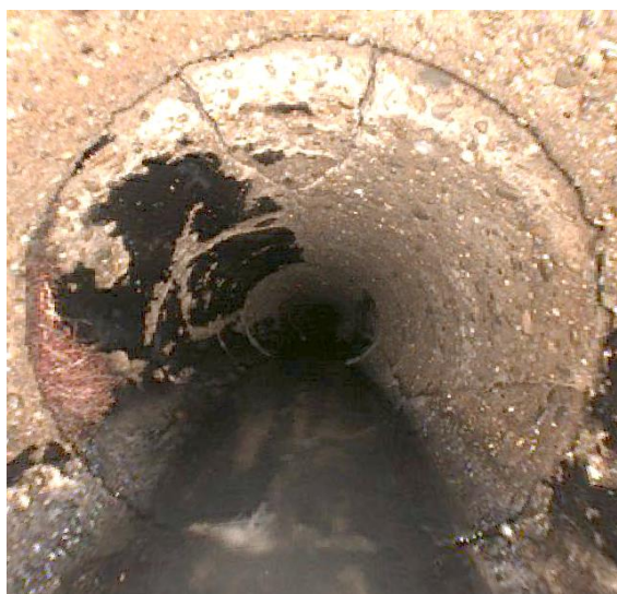
Obrázek 6-31 Zborcené potrubí na úseku Š34-Š35 [zdroj: VaK Přerov]
