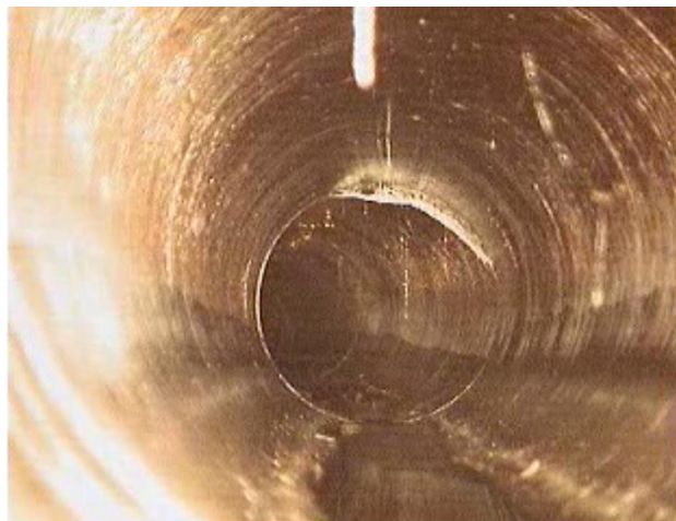
Obrázek 6-51 Potrubí Š43-Š42 [zdroj: Čagášek]
