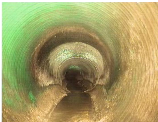
Obrázek 6-46 Deformace potrubí Š39-Š40 [zdroj: Čagášek]
