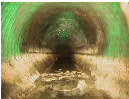
Obrázek 6-47 Usazeniny v potrubí Š41-Š40 [zdroj: Čagášek]
