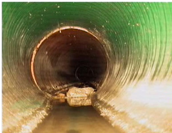
Obrázek 6-49 Pevná překážka v potrubí Š42-Š41 [zdroj: Čagášek]
