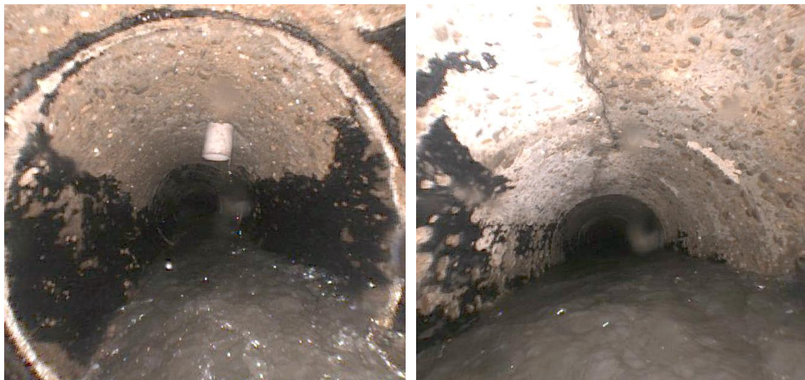
Obrázek 6-3 Přesazená přípojka a deformace potrubí na úseku OK-110 [zdroj: VaK Přerov]
