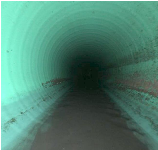
Obrázek 6-44 Mechanické opotřebení na úseku Š36-Š37 [zdroj: VaK Přerov]
