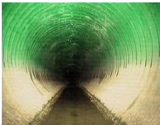
Obrázek 6-54 Mech. opotřebení potrubí Š44-Š43 [zdroj: Čagášek]
