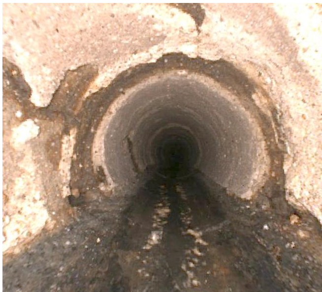
Obrázek 6-26 Prasklé potrubí s chybějícími částmi a viditelnou zeminou na úseku 142-142a [zdroj: VaK Přerov]
