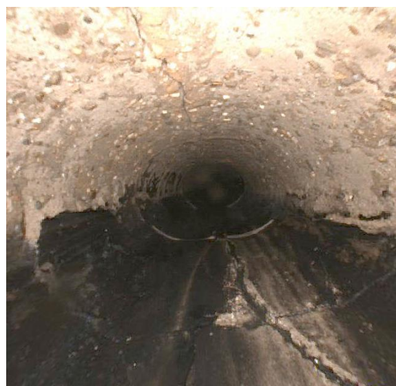
Obrázek 6-35 Zborčené potrubí na úseku Š36-133 [zdroj: VaK Přerov]
