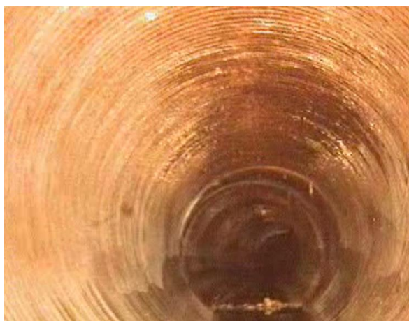
Obrázek 6-52 Usazeniny v potrubí Š43-Š42 [zdroj: Čagášek]
