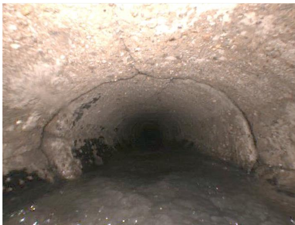
Obrázek 6-6 Zborcení potrubí na úseku 110-112 [zdroj: VaK Přerov]
