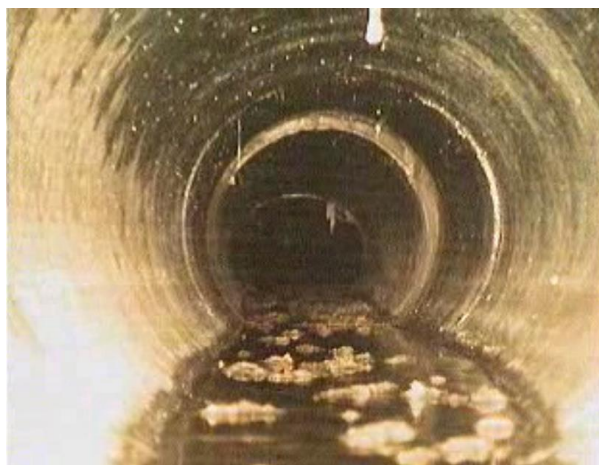
Obrázek 6-56 Usazeniny v potrubí Š45-Š44 [zdroj: Čagášek]
