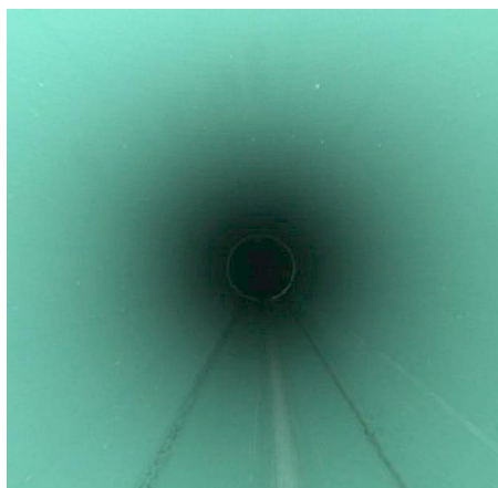
Obrázek 6-2 Mechanické opotřebení na úseku Š170-Š1 [zdroj: VaK Přerov]
