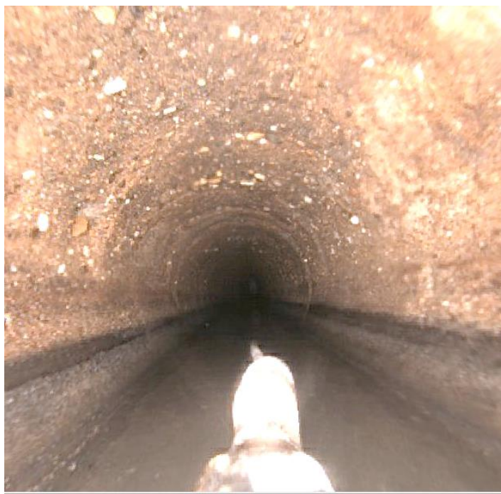
Obrázek 6-12 Mechanické a chemické poškození na úseku 129-129a [zdroj: VaK Přerov]
