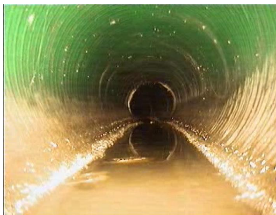
Obrázek 6-48 Potrubí Š41-Š40 [zdroj: Čagášek]
