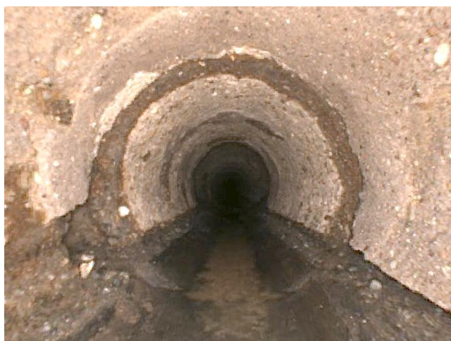
Obrázek 6-27 Prasklé potrubí s chybějícími částmi a viditelnou zeminou na úseku 142-142a [zdroj: VaK Přerov]
