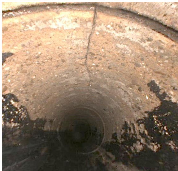
Obrázek 6-34 Prasklé potrubí na úseku Š36-133 [zdroj: VaK Přerov]
