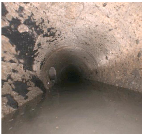
Obrázek 6-10 Prasklé potrubí na úseku 114-Š33 [zdroj: VaK Přerov]
