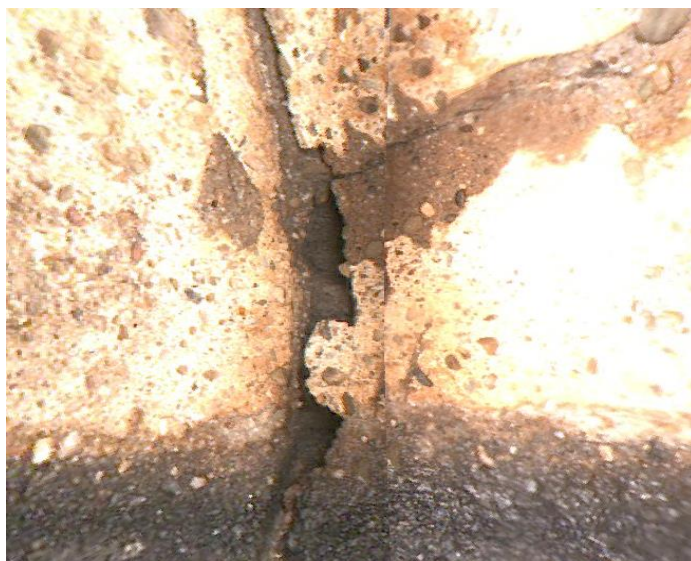
Obrázek 6-17 Prasklé potrubí s chybějící na úseku 130a-129 [zdroj: VaK Přerov]
