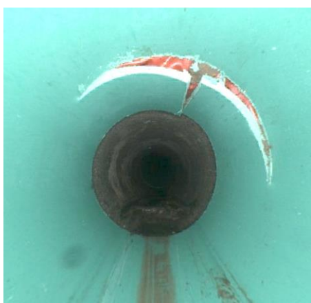
Obrázek 6-1 špatný přechod mezi materiály na úseku Š1-UV [zdroj: VaK Přerov]
