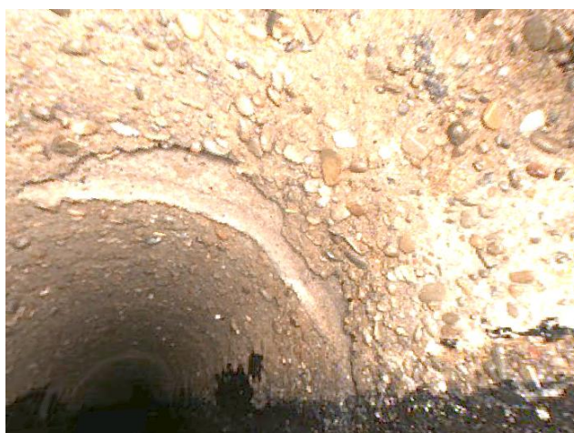
Obrázek 6-41 Prasklé potrubí na úseku napojení-19341 [zdroj: VaK Přerov]
