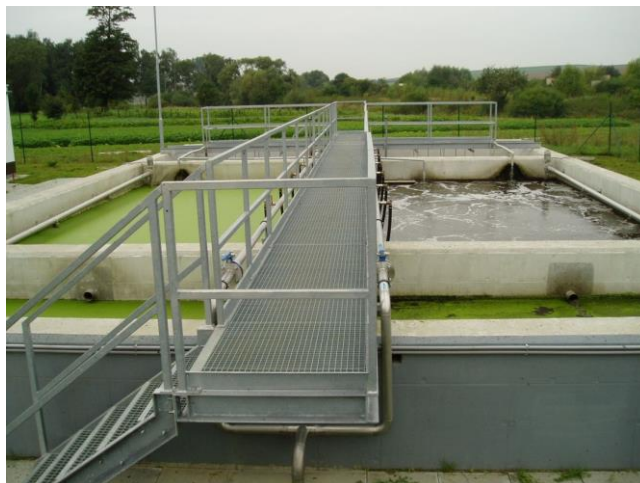
Obrázek 3-2 ČOV Dřevohostice [zdroj: Vak Přerov]
