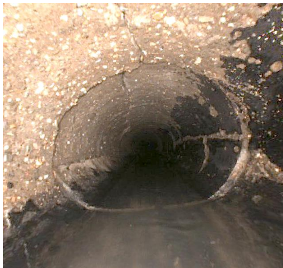
Obrázek 6-30 Zborcené potrubí na úseku Š34-Š35 [zdroj: VaK Přerov]
