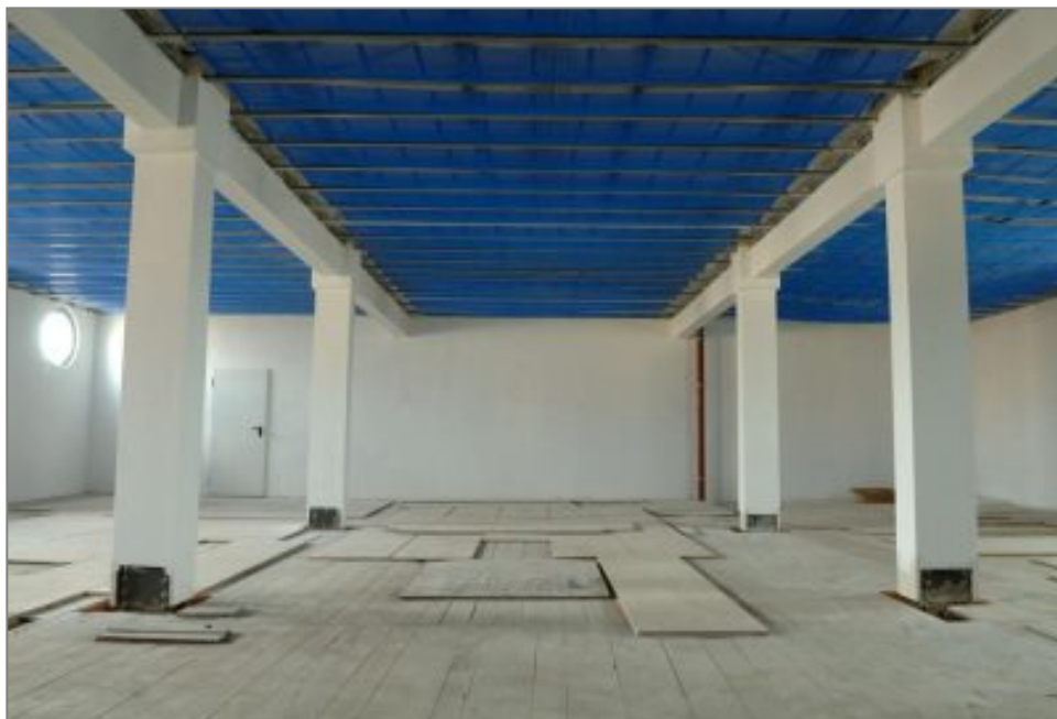
Obrázek 10. Kapilární rohože instalované v podhledu. [23]
