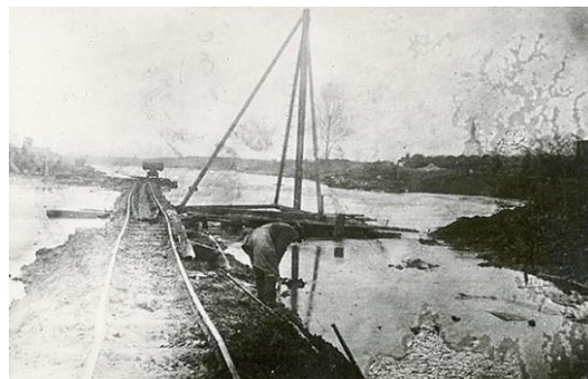
Obrázek 32 - Zatopené a poškozené staveniště regulace řeky, která se začala v tomto roce budovat – rok 1926 [35]
