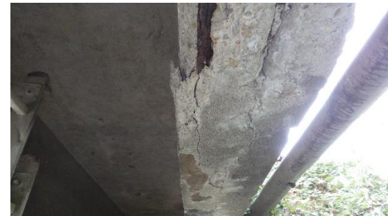
Obrázek 47: Pohled na rozpad a odpadání krycí vrstvy výztuže, beton degradovaný s viditelnými trhlinami korozí
