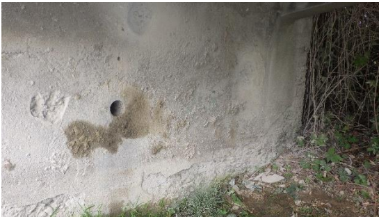
Obrázek 24: Detail opěry OP1, viditelné odpadání povrchových vrstev
