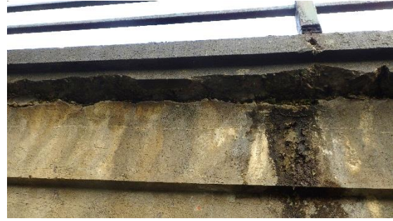
Obrázek 34: Detailní foto poškozené římsy s chybějícími částmi betonu a lokálním potečením
