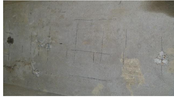
Obrázek 56: Bližší pohled na provedenou sekanou sondu SVD1
