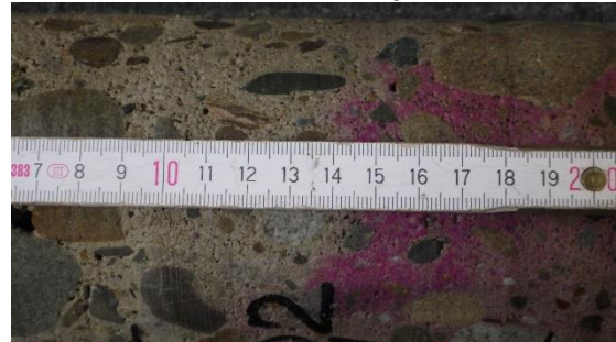
Obrázek 6: Detail hloubky karbonatace tělesa z vývrtnu VOP1
