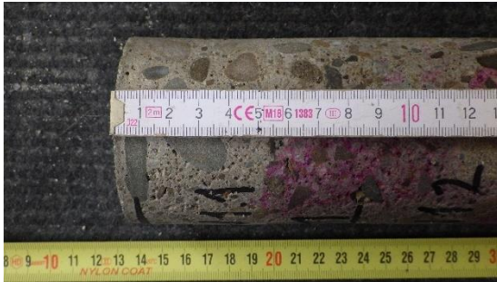
Obrázek 23: Detail měření hloubky karbonatace tělesa z výmrtu VN1 – levá strana tělesa
