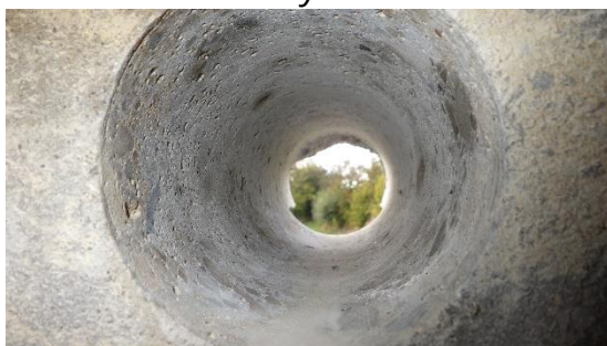
Obrázek 27: Detailní foto ostění vývrtu VN2
