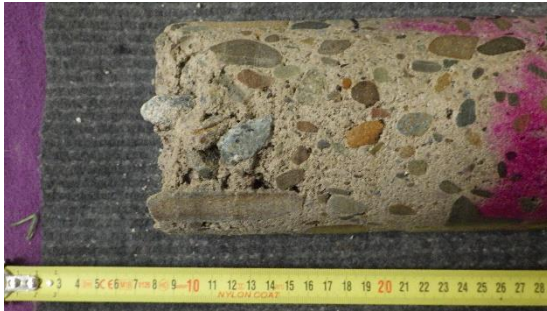
Obrázek 5: Detail špatně zhutněného betonu na začátku tělesa z vývrtnu VOP1
