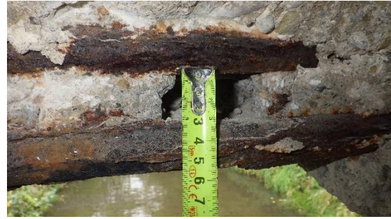
Obrázek 43: Foto měření krycí vrstvy horní řady hlavní nosné výztuže, výztuž značně zkorodována
