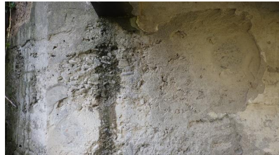
Obrázek 25: Detail opěry OP2, viditelné odpadání povrchových vrstev, zmáčení a štěrková hnízda
