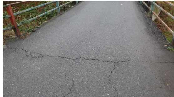
Obrázek 32: Pohled na příčnou trhlinu ve vozovce nad opěrou OP1
