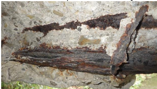
Obrázek 46: Detailní foto na šupinkovou korozi výztuže, viditelné oslabení průměru výztuže korozí
