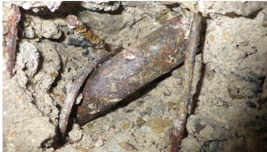
Obrázek 53: Detailní pohled na nalezený ohyb hlavní nosné výztuže v sondě SVT2, nosná výztuž i třmínky s mírnou povrchovou korozí
