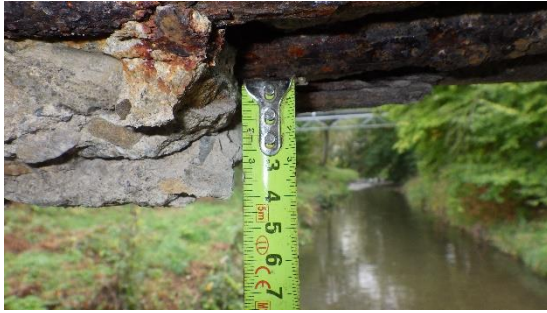
Obrázek 42: Foto měření krycí vrstvy spodní řady hlavní nosné výztuže, výztuž značně zkorodována
