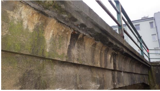
Obrázek 33: Pohled na poškozenou římsu v blízkosti opěry OP1
