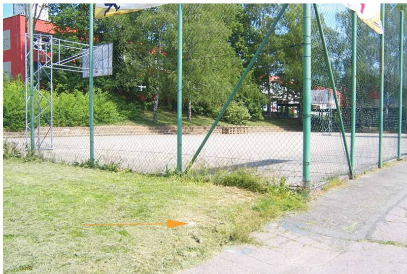
Obr. č. 22 - Poškozený ZhB – chybí ochranná tyč
