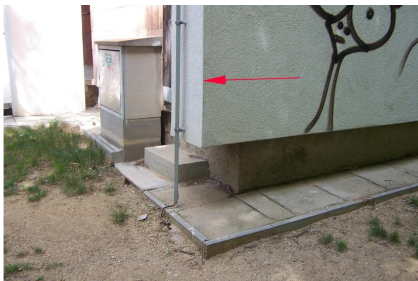
Obr. č. 25 - Zničený PPBP - zateplení
