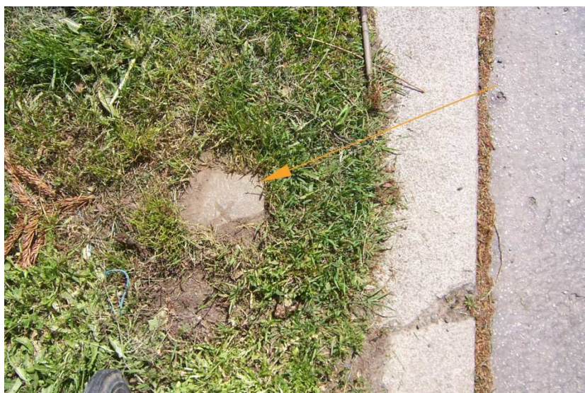
Obr. č. 23 - Poškozený PPBP – uražený roh
