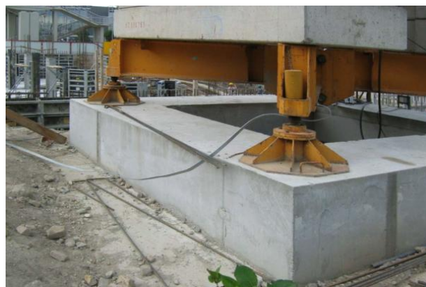
Obr. Základna věžového jeřábu
