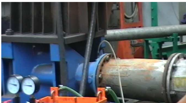
Obr. 6.2 Měření vstupního tlaku
