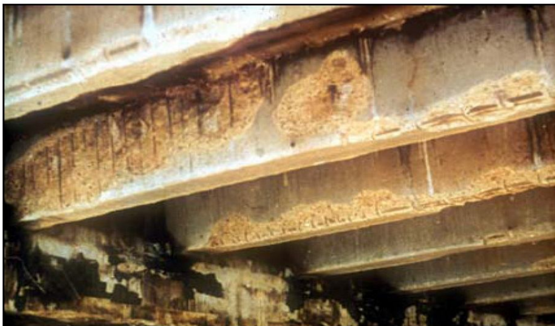
Obrázek 1- Příklad betonových prvků po požáru. Odštěpení betonu je jasně patrné [17]
