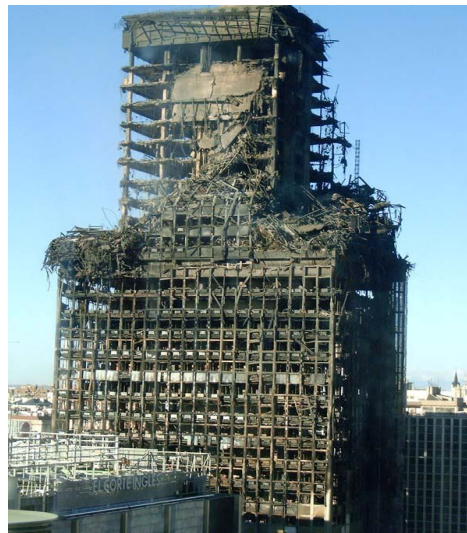
Obrázek 3 – Budova byla požárem zcela zničena, IECA, Španělsko[17]
