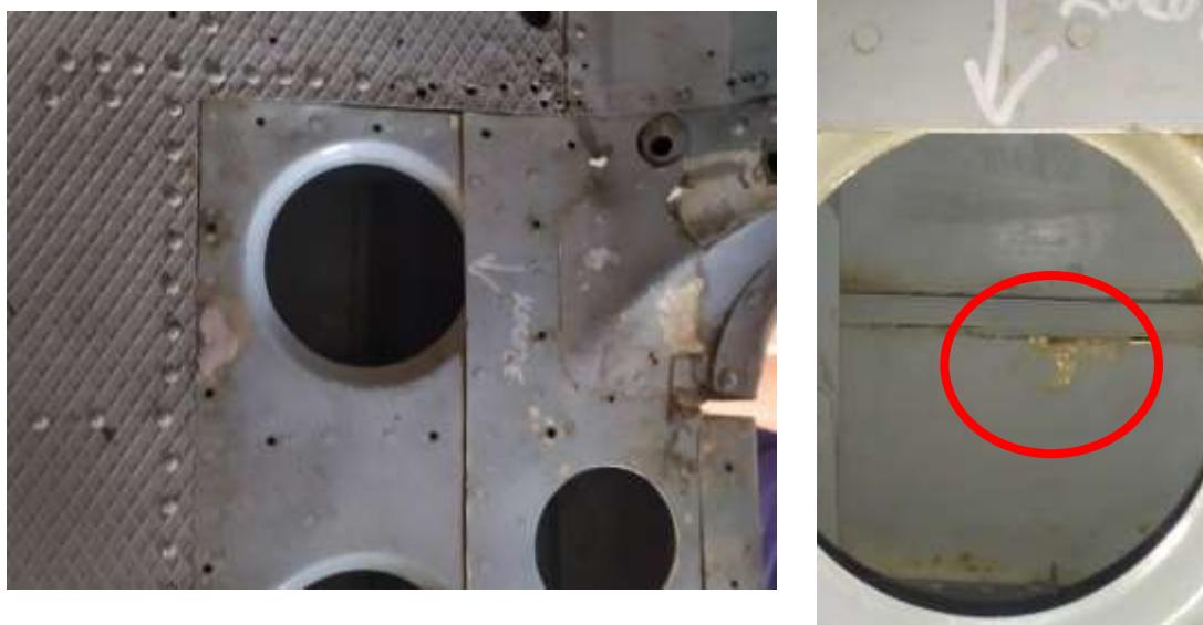
Obrázek 5.7: Koroze podlahy na vstupu
