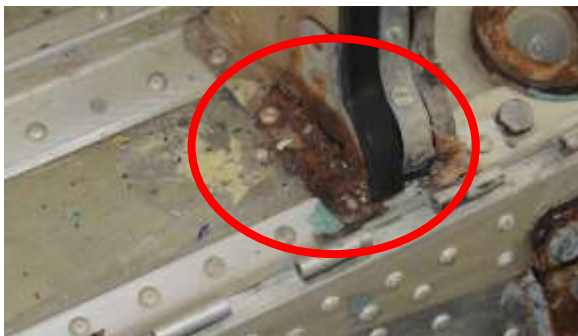
Obrázek 5.11: Destrukce protipožární přepážky
