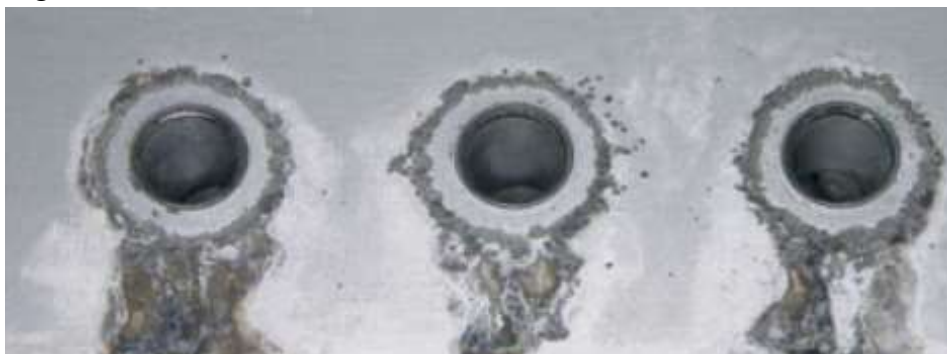
Obrázek 3.5: Galvanická koroze hliníku
