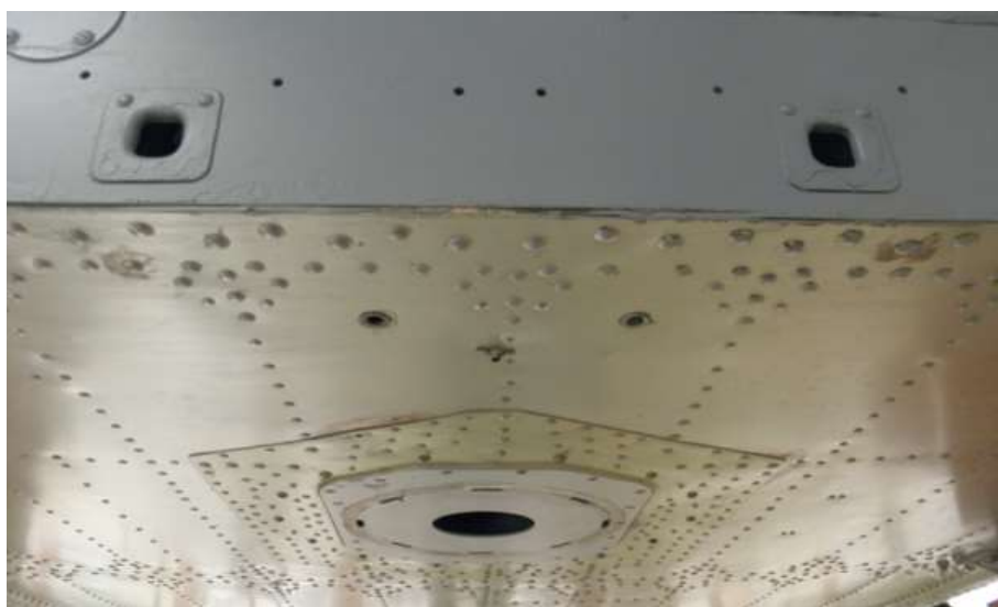
Obrázek 5.5: Trhliny v důsledku koroze na potahu
