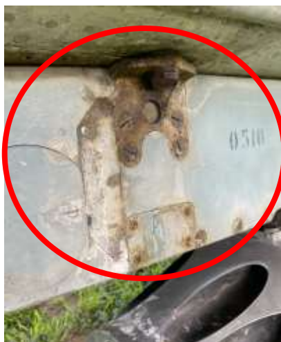
Obrázek 5.27: Koroze v místě spoje uzavíracího prostoru
