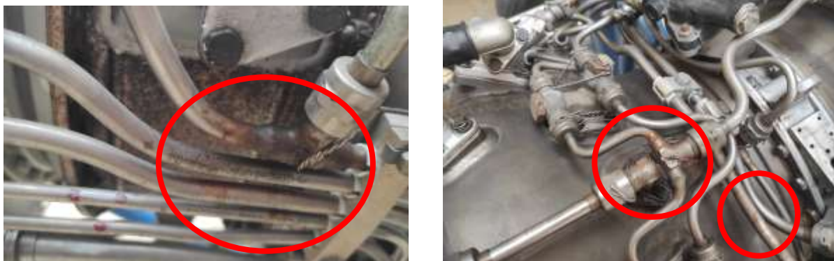
Obrázek 5.21: Koroze potrubí motoru
