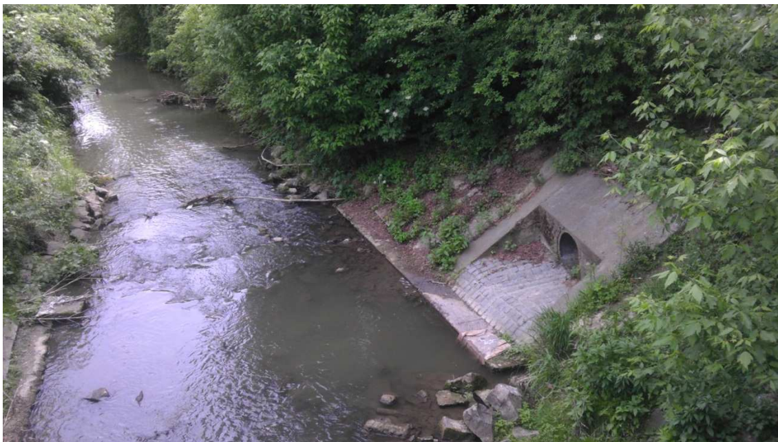
Obr. 6.5 Řiční km 52,730 dešťová výpusť u železničního křížení
