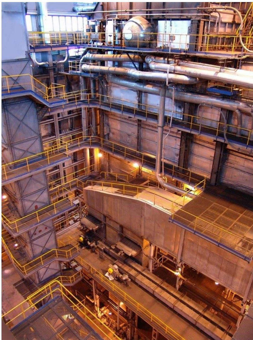
Obr. 2. Parní kotel na uhlí v elektrárně Opatovice [19]
