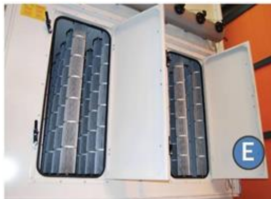
Obrázek 16 Přístup ke kontrole filtrů (Zdroj: Interní zdroje)
