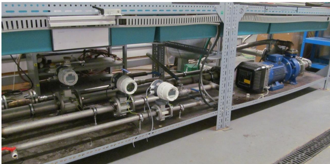
Obrázek 19: Potrubí testovací trati v původním stavu
