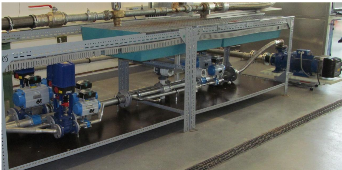
Obrázek 23: Zkompletované potrubí včetně ventilů a průtokoměrů
