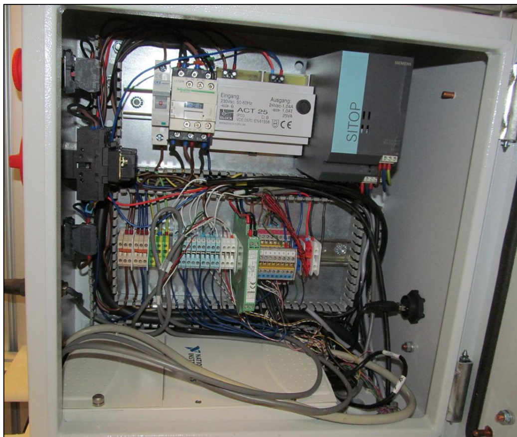
Obrázek 10: Rozváděč s měřicí elektronikou
