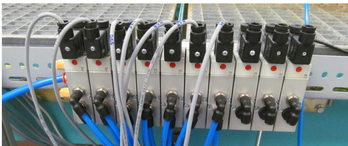
Obrázek 28: detail připojení baterie 5/2 ventilů ovládajících pneumatické pohony
