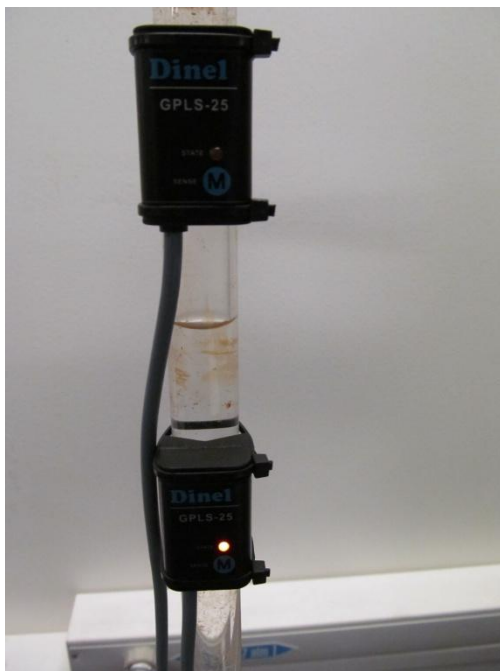
Obrázek 33: Detekce hladiny nádrže přes stěnu stavoznaku.
