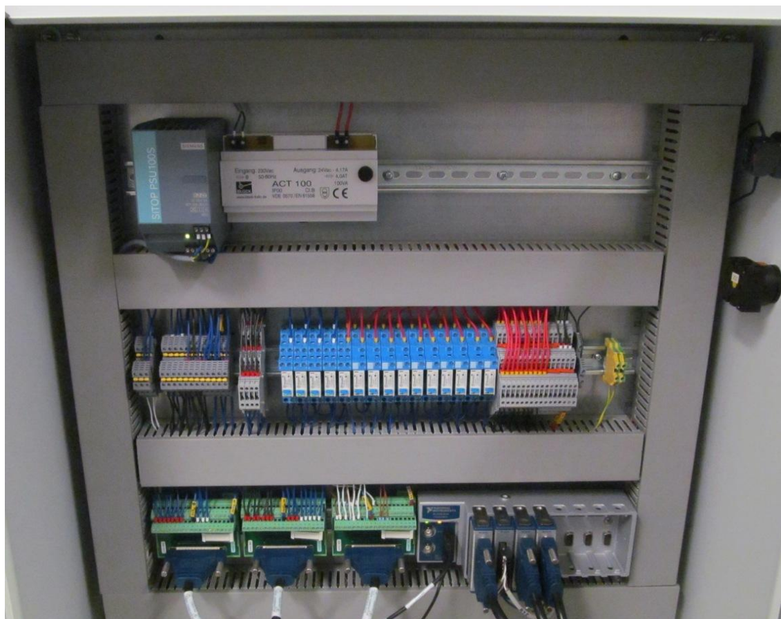
Obrázek 31: Výsledná realizace měřicího a ovládacího rozváděče.
