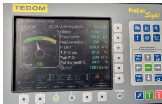
Obr. 82 Řídící panel kogenerační jednotky [107]
