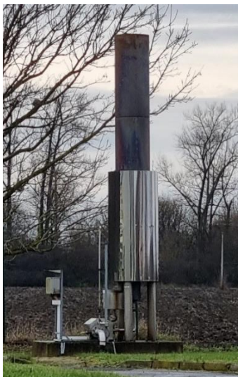
Obr. 85 Fléra (hořák zbytkového bioplynu) ZLB 260 A [107]
