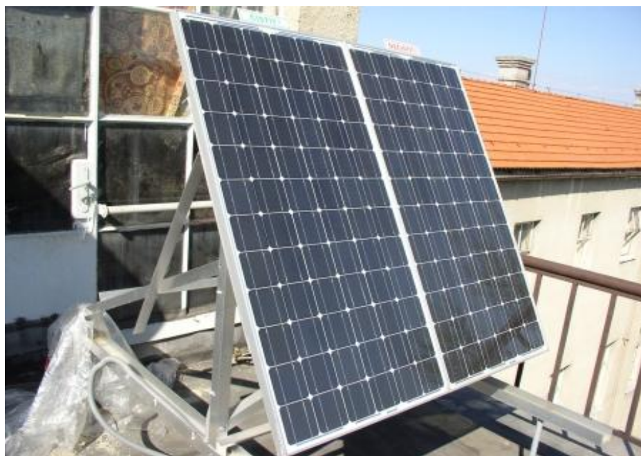
FV systém na terase budovy Údolní 53 [22].
