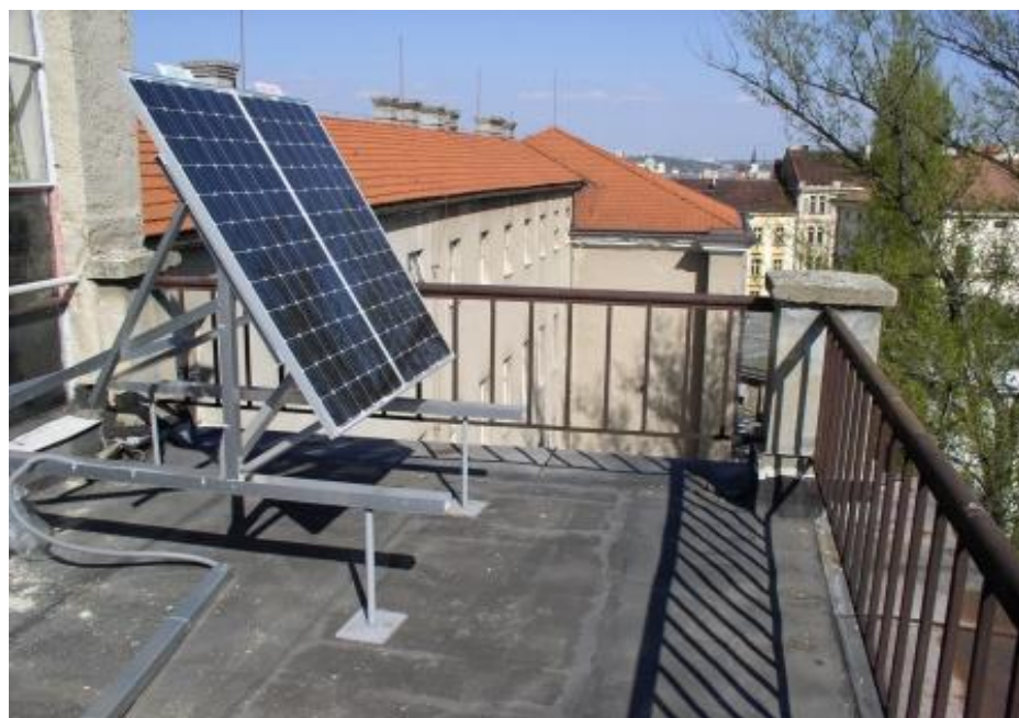
FV systém na terase budovy Údolní 53 [22].
