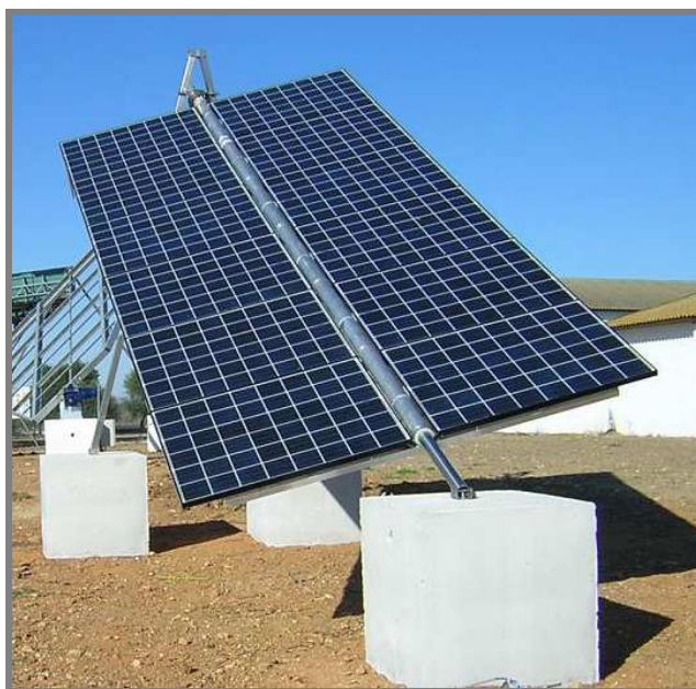
Obr. 1-6 Elektrárna s možností natočení kolem jedné osy [10]
