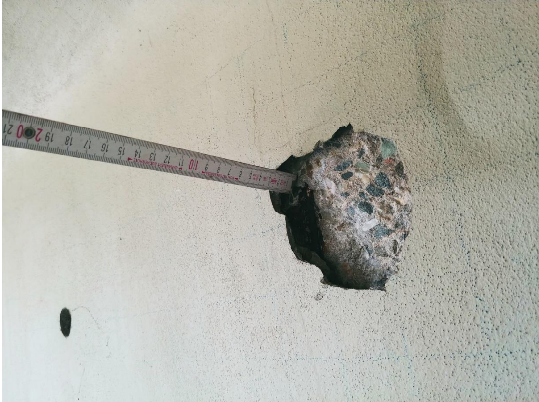
Obr. 3.1.2 – Odtržení sanační vrstvy na fasádním nosníku.
