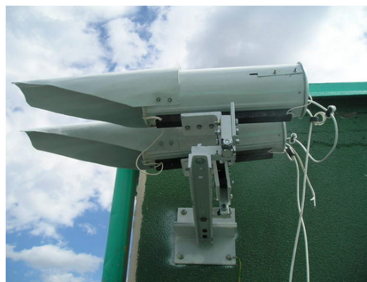
(b) Fotografie nainstalovaného zařízení
