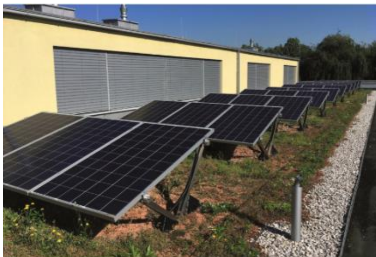
Obrázek 4 Ukázka realizace biosolární zelené střechy [9]
