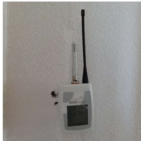
Obrázek 27 Umístění čidla - Bazén
