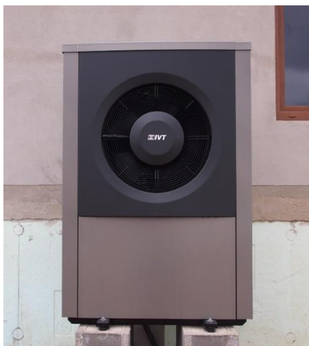
Obrázek 9.5 Tepelné čerpadlo nainstalované v modelovém domě
