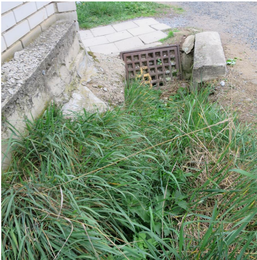
Obr. 18. Zarostlý příkop a zanesená kanalizační vpust' kritického profilu
