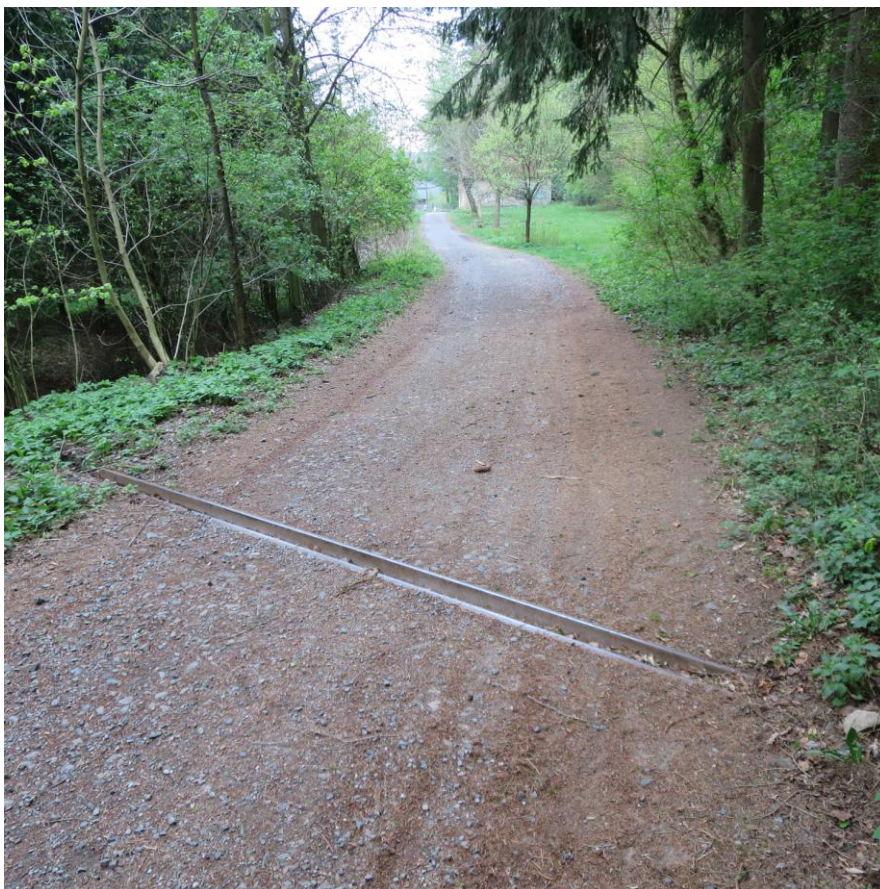
Obr. 12. Z části zanesené svodné žlábků u hranice s intravilánem
