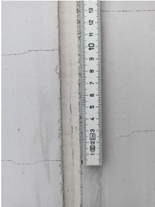
Obr. 10 Porušení tmeleného spoje u Akrylového tmelu expres
