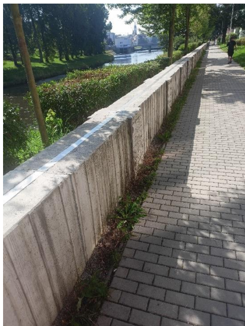
Obr. 20 Levý břeh řeky Otavy s realizovanou protipovodňovou stěnou
