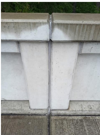
Obr. 16 Porušení tmeleného spoje zábradlí hráze vodní nádrže Kružberk
