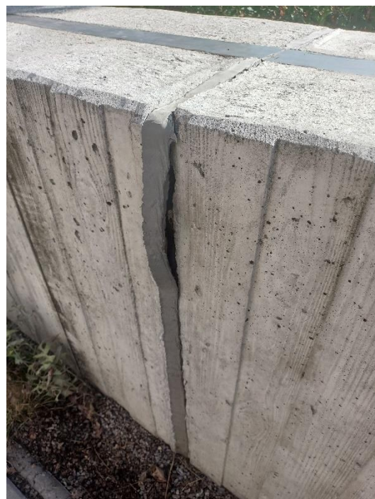
Obr. 22 Detail porušení tmeleného spoje protipovodňové stěny II
