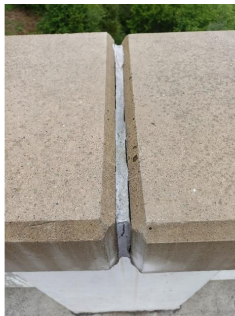
Obr. 17 Detail porušení tmeleného spoje zábradlí hráze vodní nádrže Kružberk
