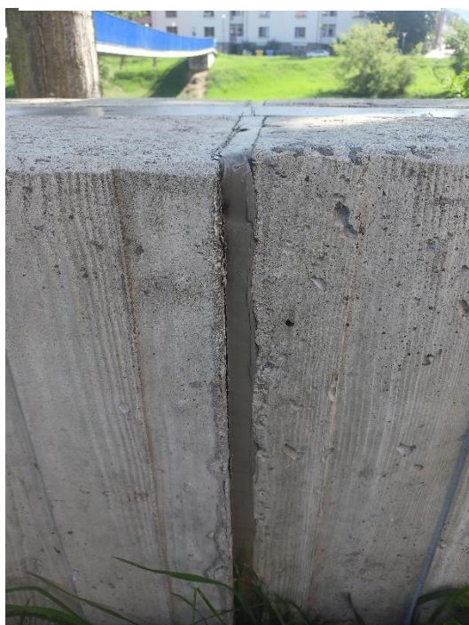
Obr. 21 Detail porušení tmeleného spoje protipovodňové stěny I
