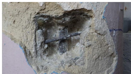
Obr. 120 Detailní pohled na odhalenou svislou výztuž a třmínek sloupu v 1. NP v rámci sondy S1.5, výztuže bez povrchové koroze, bez známek mechanického poškození
