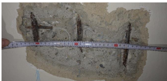
Obr. 156 Detailní pohled na provedenou sekanou sondu D1.3 uprostřed rozpětí spodního líce s odhalenými výztužemi s měřením jednotlivých roztečí
