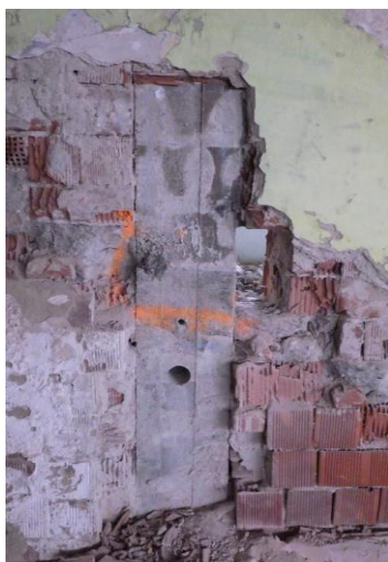
Obr. 110 Pohled na sloup v 1. NP s provedenými sondami za účelem určení skutečného vyztužení (sonda S1.4) v interiéru
