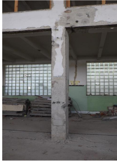
Obr. 90 Pohled na sloup v 1. NP s provedenými sondami za účelem určení skutečného vyztužení (sonda S1.1)
