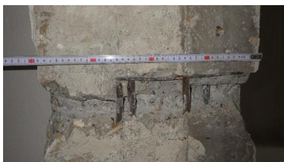
Obr. 127 Detailní pohled na provedenou sekanou sondu v rámci sondy P1.1 uprostřed rozpětí spodního líce s odhalenými výztužemi
