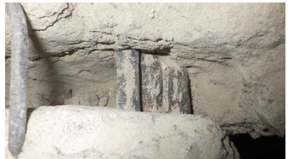
Obr. 149 Detailní foto provedené sekané sondy v rámci T1.2 u horního povrchu u podpory s odhalenými třemi podélnými výztužemi
