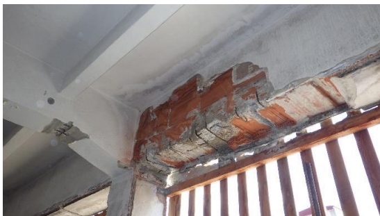
Obr. 237 Pohled na provedenou sekanou sondu v rámci sondy P3.2 uprostřed rozpětí a u vybrané podpory spodního líce s odhalenými výztužemi
