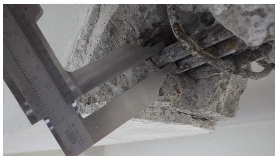
Obr. 229 Měření průměru hlavní nosné výztuže žebra v rámci sondy T3.1 posuvným měřítkem
