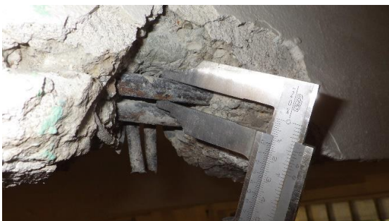
Obr. 138 Měření průměru hlavní nosné výztuže žebra v rámci sondy T1.1 posuvným měřítkem
