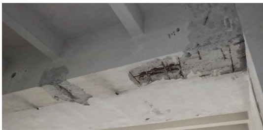
Obr. 185 Pohled na provedenou sekanou sondu v rámci sondy P2.2 uprostřed rozpětí spodního líce s odhalenými výztužemi a s oblastí s odpadnou krycí vrstvou betonu v místě ohybů
