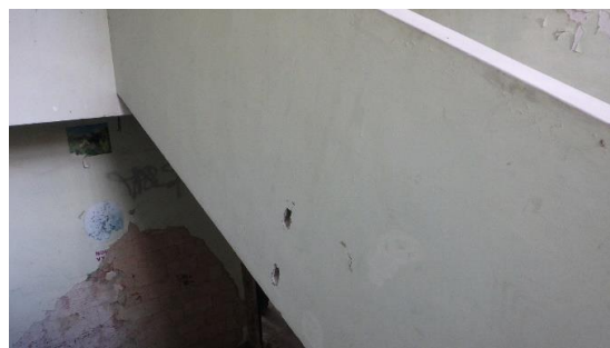
Obr. 205 Pohled na zábradelní železobetonovou stěnu s provedenými sekanými sondami v rámci D2.3 u dvou spodních oblastí nalezených výztuží
