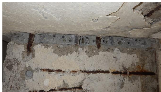
Obr. 190 Detail sekané sondy v rámci P2.2 u podpory za účelem prokázání počtu průběžných výztuží
