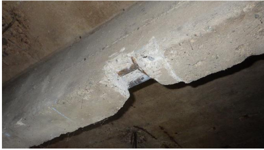
Obr. 144 Detailní pohled na provedenou sekanou sondu v rámci sondy T1.2 uprostřed rozpětí spodního líce s odhalenými výztužemi
