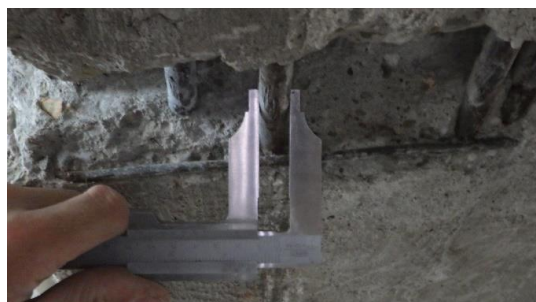
Obr. 131 Měření průměru hlavní nosné výztuže průvlaku v rámci sondy P1.1 posuvným měřítkem
