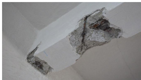
Obr. 226 Detailní foto provedených sekaných sond v rámci sondy T3.1 s nalezenou polohou ohybu a s prokázaným zatažením dvou výztuží do podpory
