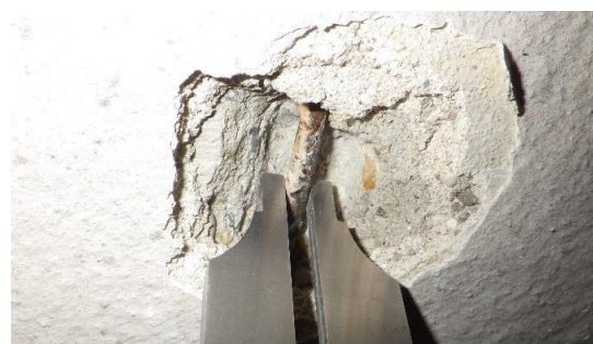
Obr. 202 Detailní pohled na provedenou sekanou sondu D2.2 uprostřed rozpětí spodního líce s odhalenými výztužemi s měřením profilu nosné výztuže desky
