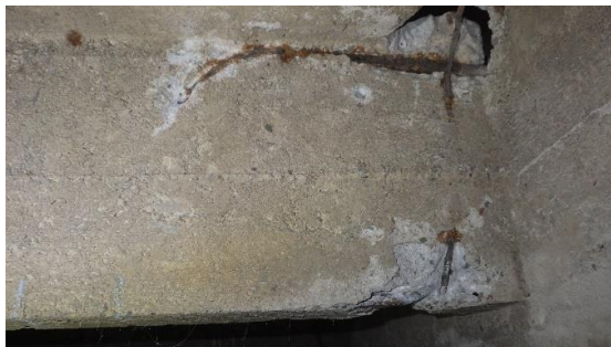
Obr. 148 Foto detailu v rámci sondy T1.2 u vybrané podpory s viditelným ohybem od horního líce s nízkým krytím a s výztuží, která se u podpory ve vzdálenosti cca 80 mm rovněž začíná ohýbat k hornímu povrchu
