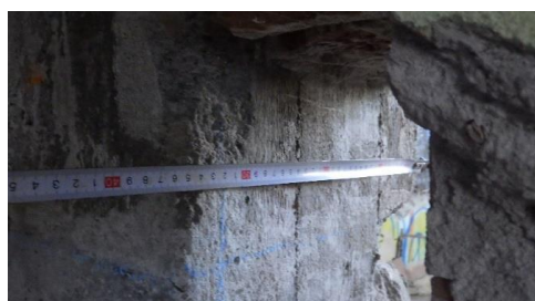
Obr. 113 Detailní pohled na provedenou oblast sekaných sond za účelem ověření skutečného vyztužení sloupu s rozměřením rozteční jednotlivých výztuží (boční stěna sloupu)
