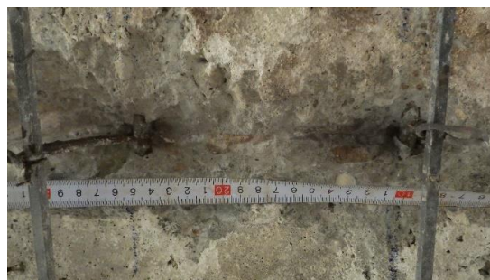
Obr. 245 Detailní pohled na provedenou sondu D3.2 s měřením roztečí výztuží
