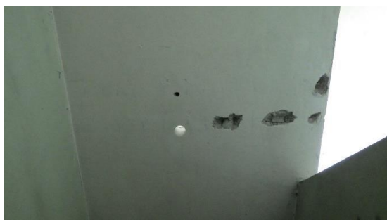
Obr. 204 Pohled na provedenou profometrickou kontrolu polohy výztuží včetně provedených sekaných sond v rámci sondy D2.3 na spodním líci výstupního schodišťového ramena do 3. NP
