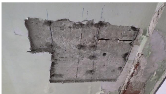
Obr. 244 Pohled na provedenou sondu D3.2 uprostřed rozpětí spodního líce s odhalenými výztužemi
