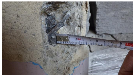
Obr. 122 Detailní foto měření krycích vrstev betonu vybrané hlavní nosné výztuže sloupu v rámci provedené sondy S1.5
