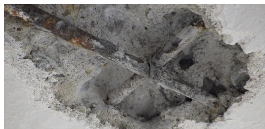
Obr. 233 Detailní pohled na provedenou sekanou sondu v rámci sondy D3.1 uprostřed rozpětí s odhalenými výztužemi s mírnou povrchovou korozí
