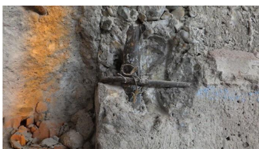
Obr. 114 Detailní pohled na odhalenou svislou výztuž a třmínek sloupu v 1. NP v rámci sondy S1.4, výztuže s velmi mírnou povrchovou korozí, bez známek mechanického poškození
