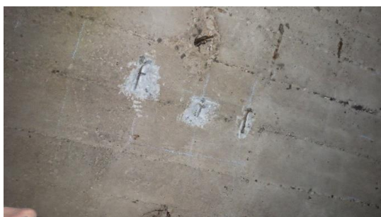
Obr. 151 Pohled na provedenou sekanou sondu v rámci sondy D1.2 uprostřed rozpětí spodního líce s odhalenými výztužemi
