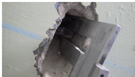
Obr. 209 Měření profilu spodní konstrukční výztuže v rámci sondy D2.3 zábradelní železobetonové stěny posuvným měřítkem
