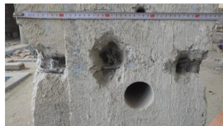
Obr. 88 Detailní pohled na provedenou oblast sekaných sond v rámci sondy S1.1 s rozměřeními rozteční jednotlivých výztuží
