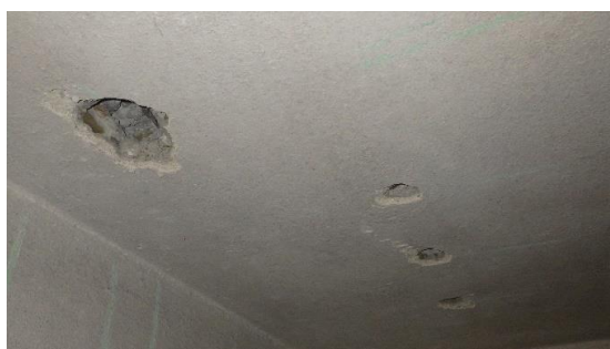
Obr. 201 Pohled na provedenou sekanou sondu D2.2 uprostřed rozpětí spodního líce s odhalenými výztužemi
