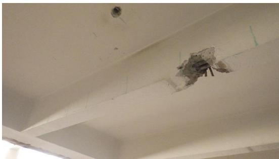
Obr. 134 Detailní pohled na provedenou sekanou sondu v rámci sondy T1.1 uprostřed rozpětí spodního líce s odhalenými výztužemi
