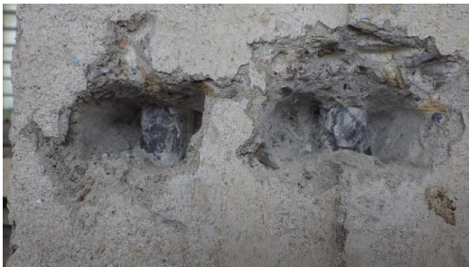
Obr. 91 Detailní pohled na dvě odhalené svislé nosné výztuže sloupu v 1. NP v rámci sondy S1.1, výztuže bez povrchové koroze, bez známek mechanického poškození
