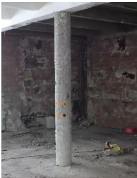
Obr. 103 Pohled na sloup v 1. NP s provedenými sondami za účelem určení skutečného vyztužení (sonda S1.3)
