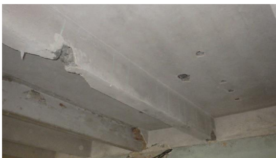
Obr. 194 Detailní pohled na provedenou sekanou sondu v rámci sondy T2.2 uprostřed rozpětí spodního líce s odhalenými výztužemi
