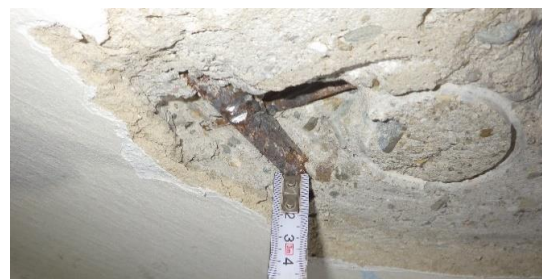
Obr. 157 Pohled na provedenou sekanou sondu D1.3 s měřením krycích vrstev betonu nosné výztuže desky
