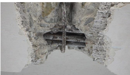
Obr. 227 Detailní foto vyztužení v rámci sondy T3.1 uprostřed rozpětí s odhalenými výztužemi
