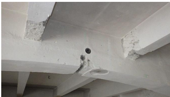
Obr. 166 Pohled na provedenou sekanou sondu P2.1 uprostřed rozpětí spodního líce obloukového průvlastku nad 2. NP s odhalenými výztužemi
