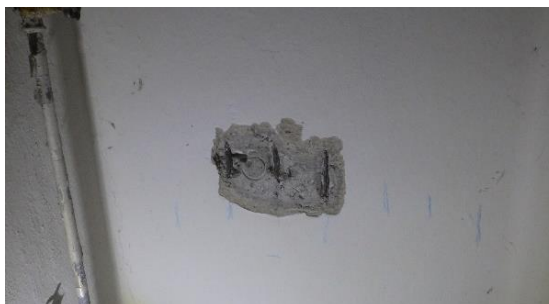
Obr. 154 Pohled na provedenou sekanou sondu v rámci sondy D1.3 uprostřed rozpětí spodního líce s odhalenými výztužemi a naznačenými výztužemi zjištěnými pomocí georadaru a profometru
