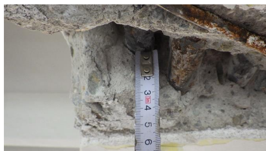
Obr. 221 Měření krycích vrstev betonu hlavní nosné výztuže střešního průvlaku v místě sondy P3.1
