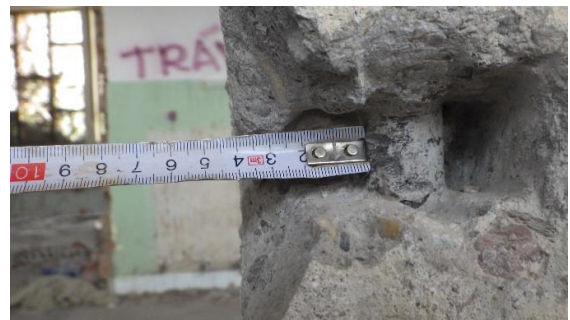
Obr. 99 Detailní foto měření krycích vrstev betonu vybrané rohové hlavní nosné výztuže sloupu v rámci provedené sondy S1.2
