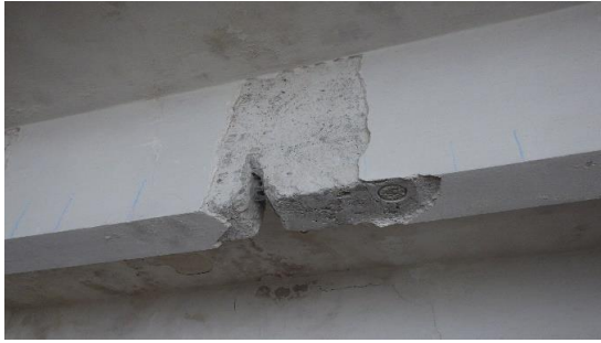
Obr. 173 Detailní pohled na provedenou sekanou sondu v rámci sondy T2.1 uprostřed rozpětí spodního líce s odhalenými výztužemi
