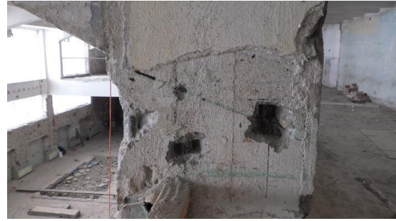
Obr. 160 Detailní pohled na provedenou oblast sekaných sond v rámci S2.1 za účelem ověření skutečného vyztužení sloupu, v pohledu viditelný šikmo umístěný třmínek navazující na linii spodního líce železobetonového oblouku
