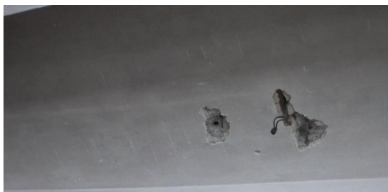
Obr. 180 Pohled na provedenou sekanou sondu v rámci sondy D2.1 uprostřed rozpětí spodního líce s odhalenými výztužemi
