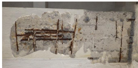
Obr. 186 Detailní pohled na místo v rámci P2.2 s odpadnou krycí vrstvou betonu s výrazně povrchově korodující výztuží v místě ohýbajících se výztuží k hornímu povrchu
