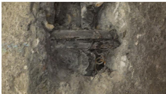
Obr. 105 Detailní pohled na odhalenou svislou výztuž a třmínek sloupu v 1. NP v rámci sondy S1.3, výztuže bez povrchové koroze, bez známek mechanického poškození.
