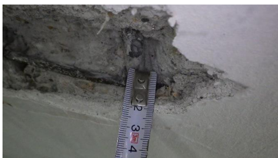
Obr. 206 Měření krycích vrstev betonu hlavní nosné výztuže v rámci sondy D2.3 schodišťového ramena
