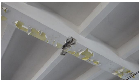
Obr. 218 Pohled na provedenou sekanou sondu v rámci sondy P3.1 uprostřed rozpětí spodního líce s odhalenými výztužemi
