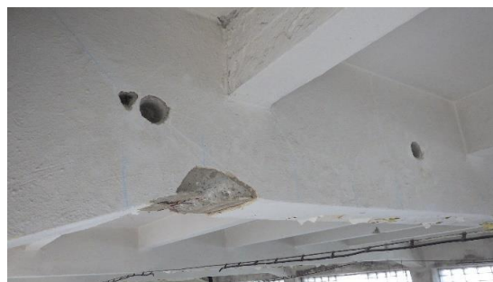
Obr. 219 Pohled na rozkreslené polohy třmínků na bočním líci průvlaku v rámci sondy P3.1 s doplňkovými sekanými sondami
