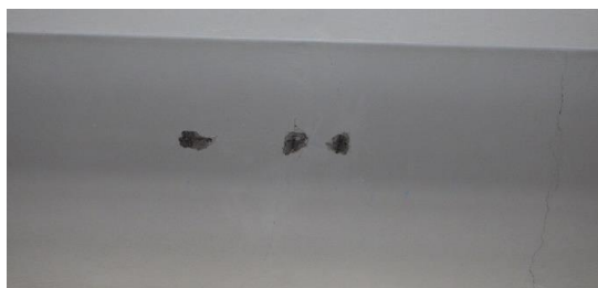
Obr. 232 Pohled na provedenou sekanou sondu v rámci sondy D3.1 uprostřed rozpětí spodního líce s odhalenými výztužemi
