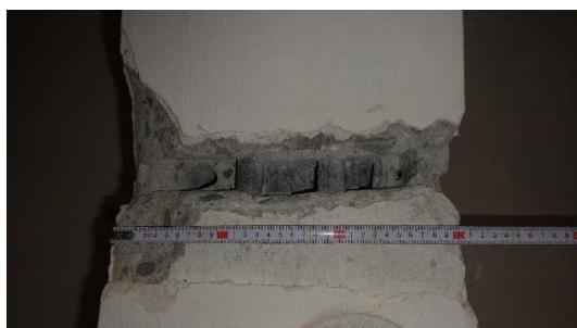
Obr. 168 Detailní pohled na provedenou sekanou sondu v rámci sondy P2.1 uprostřed rozpětí spodního líce s odhalenými výztužemi
