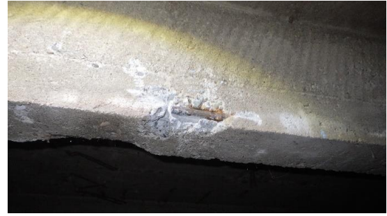
Obr. 145 Fotografie místa v rámci sondy T1.2 s ukončenou jednou podélnou výztuží ve vzdálenosti cca 660 mm od podpory
