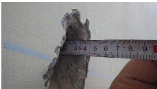
Obr. 208 Měření krycích vrstev betonu konstrukční výztuže v rámci sondy D2.3 zábradelní železobetonové stěny
