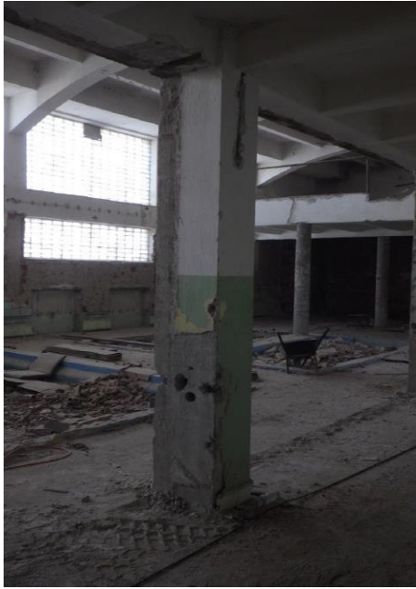
Obr. 89 Pohled na sloup v 1. NP s provedenými sondami za účelem určení skutečného vyztužení (sonda S1.1)
