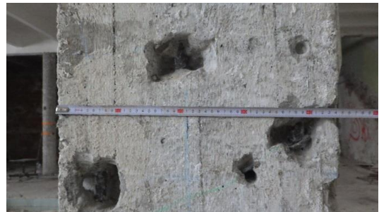
Obr. 97 Detailní pohled na provedenou oblast sekaných sond za účelem ověření skutečného vyztužení sloupu s rozměřením rozteční jednotlivých výztuží
