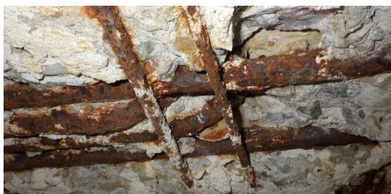
Obr. 187 Detailní pohled na místo v rámci P2.2 s odpadnou krycí vrstvou betonu s výrazně povrchově korodující výztuží v místě ohýbajících se výztuží k hornímu povrchu
