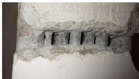
Obr. 169 Detailní pohled na povrch odhalených výztuží v rámci sondy P2.1, povrch jednotlivých výztuží bez viditelné koroze
