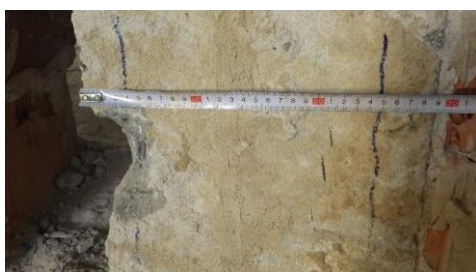
Obr. 112 Detailní pohled na provedenou oblast sekaných sond za účelem ověření skutečného vyztužení sloupu s rozměřením rozteční jednotlivých výztuží (čelní stěna z exteriéru)
