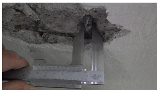
Obr. 207 Měření průměru hlavní podélné nosné výztuže v rámci sondy D2.3 schodišťového ramena, výztuže s velmi mírnou povrchovou korozí posuvným měřítkem
