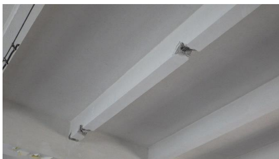
Obr. 225 Pohled na provedenou sekanou sondu v rámci sondy T3.1 uprostřed rozpětí spodního líce s odhalenými výztužemi
