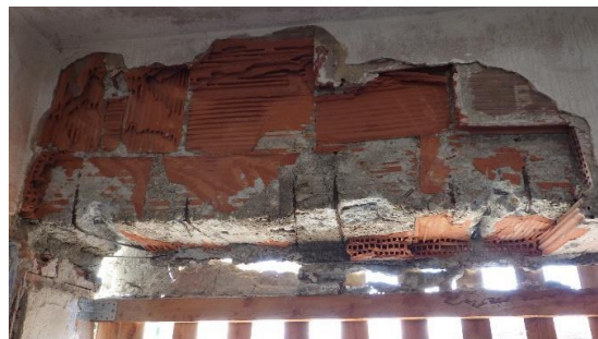
Obr. 238 Detailní foto sondy s odstraněnými cihelnými prvky v rámci sondy P3.2 odhalené třmínky na povrchu s nulovým krytím a povrchovou korozi
