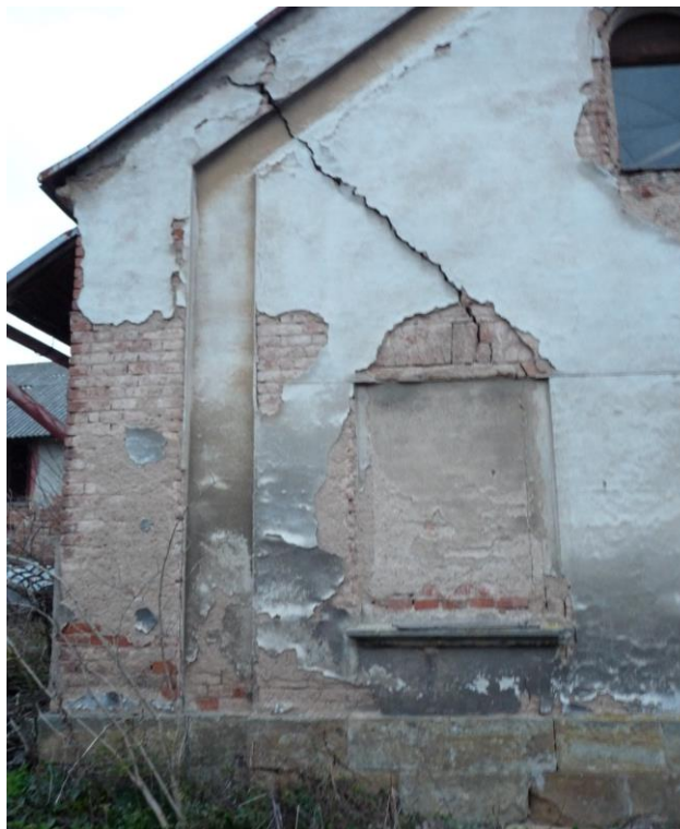
Obr. 9 Šikmá trhlina v obvodovém zdivu poukazující na možný problém
