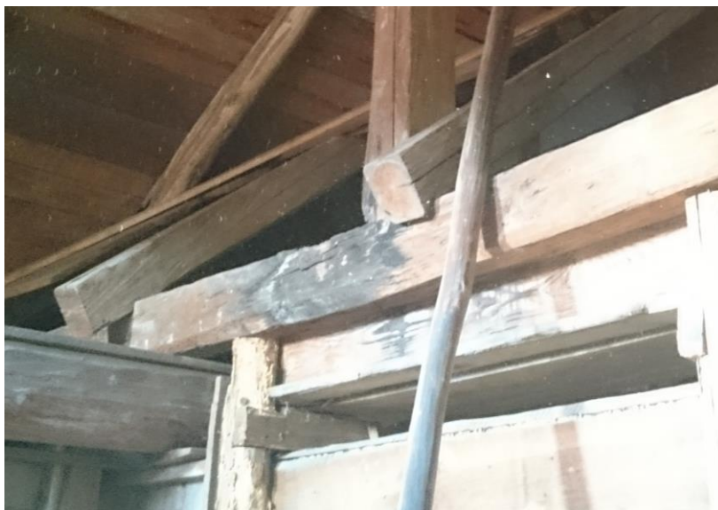
Obr. 26 Ohořelé prvky konstrukce vikýře
