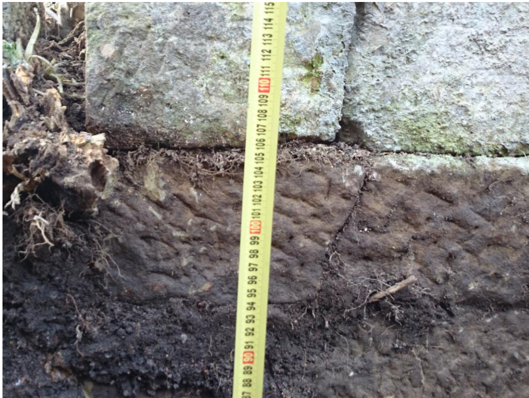
Obr. 31 Trhlina v kvádru základové konstrukce
