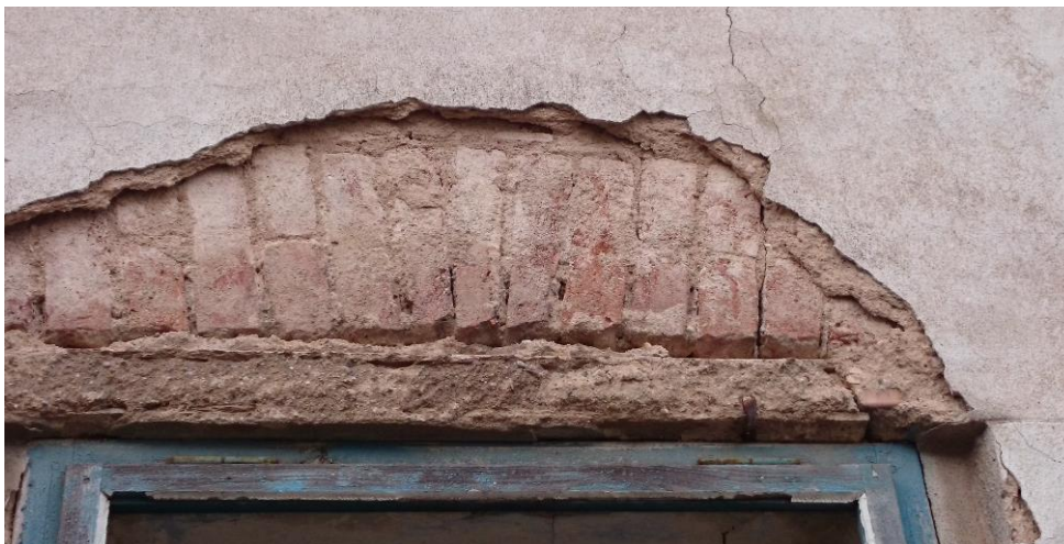
Obr. 21 Příklad porušení klenbového nadpraží
