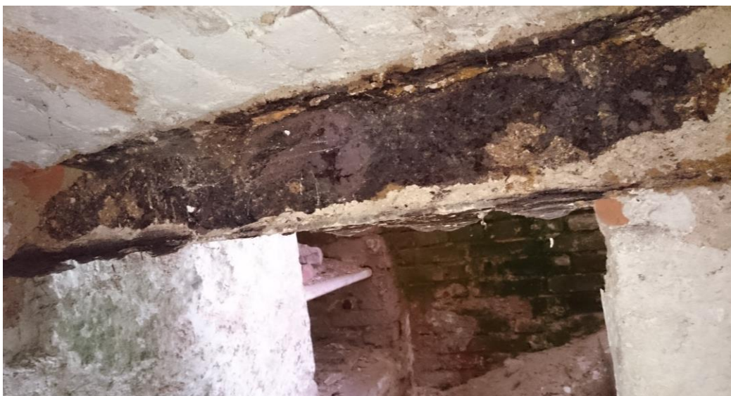
Obr. 22 Zkorodovaný překlad v 1. PP
