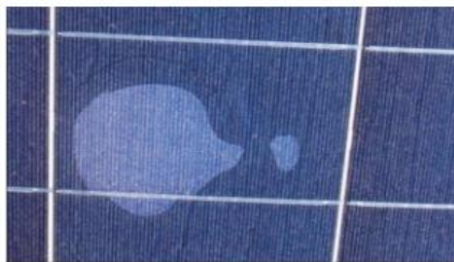
Obrázek 2-11 Delaminace fotovoltaického panelu [13]
