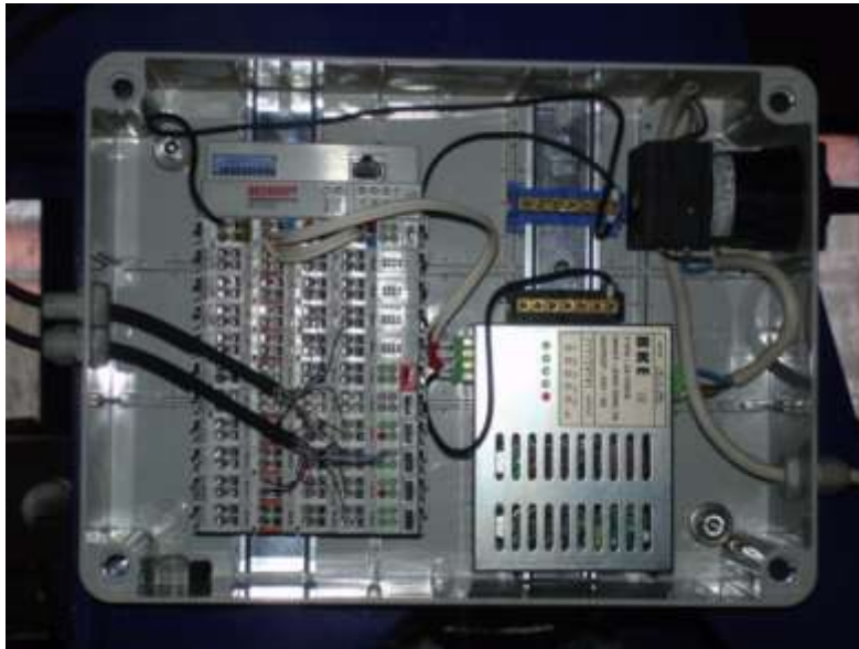
Obr. 106: PLC firmy Beckhoff pro sběr dat
