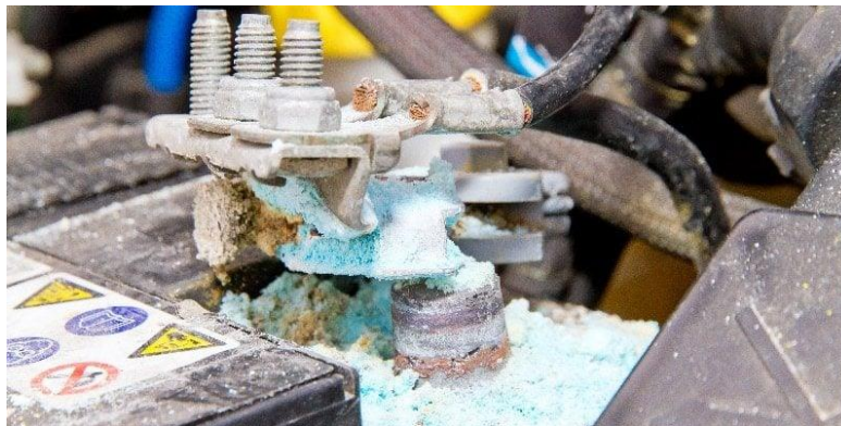
Obr. 19 Projev sulfatace u autobaterie [22]
