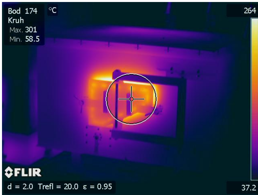
Obr. 7 Snímek termokamery - dvířka zplyňovací komory
