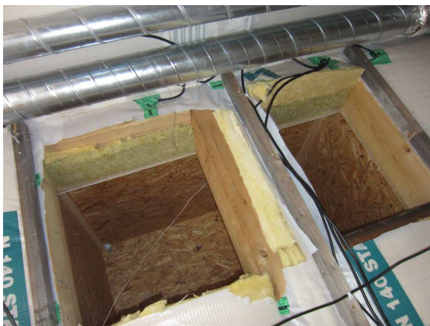
Obr. 66) Realizace parozábrany bez parotěsného napojení na ostatní konstrukce [zdroj: archiv autora]
