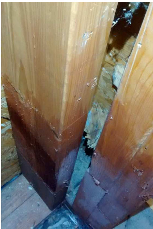
Obr. 60) Degradace vnitřního sloupku dosahující do výšky až 30 cm [zdroj: archiv autora]
