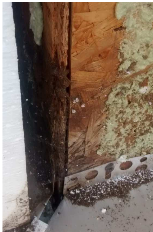
Obr. 59) Degradace opláštění z OSB desek vlivem zasažení prvků vlhkostí, pohled po odstranění kontaktního zateplovacího systému [zdroj: archiv autora]
