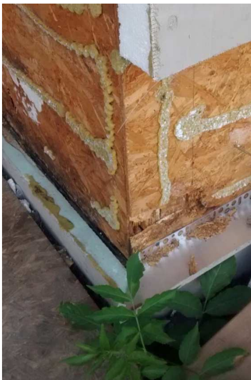
Obr. 58) Degradace opláštění z OSB desek vlivem zasažení prvků vlhkostí, pohled po odstranění kontaktního zateplovacího systému [zdroj: archiv autora]
