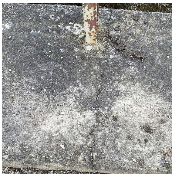
Obrázek 141: Trhlinka levé římsy
