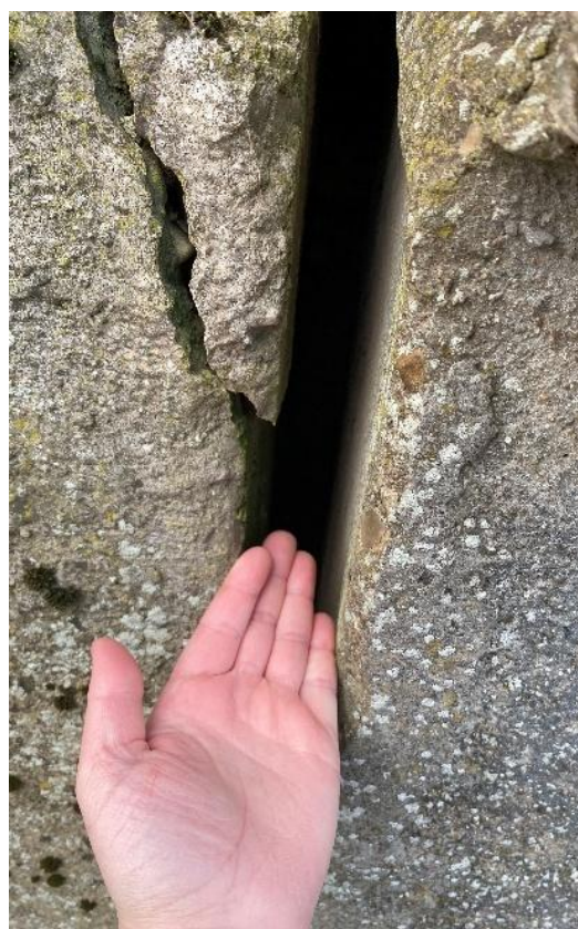
Obrázek 125: Detail široce rozevřené spáry v horní části křídla DP1
