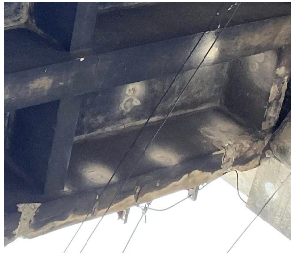
Obrázek 20: Porušená krycí vrstva betonu a místy patrná obnažená smyková výztuž
