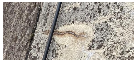
Obrázek 122: Detail trhlinky křídla OP1
