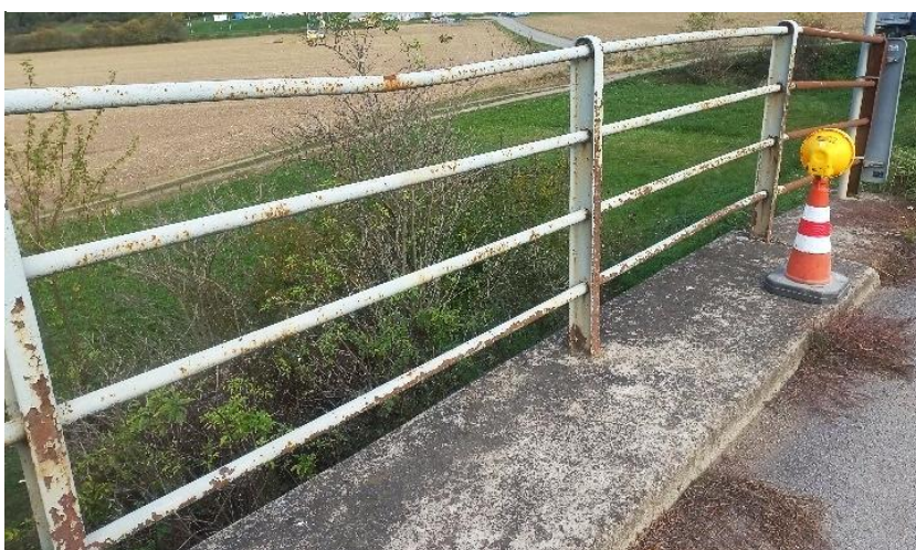
Obrázek 170: Prohnuté levé zábradlí
