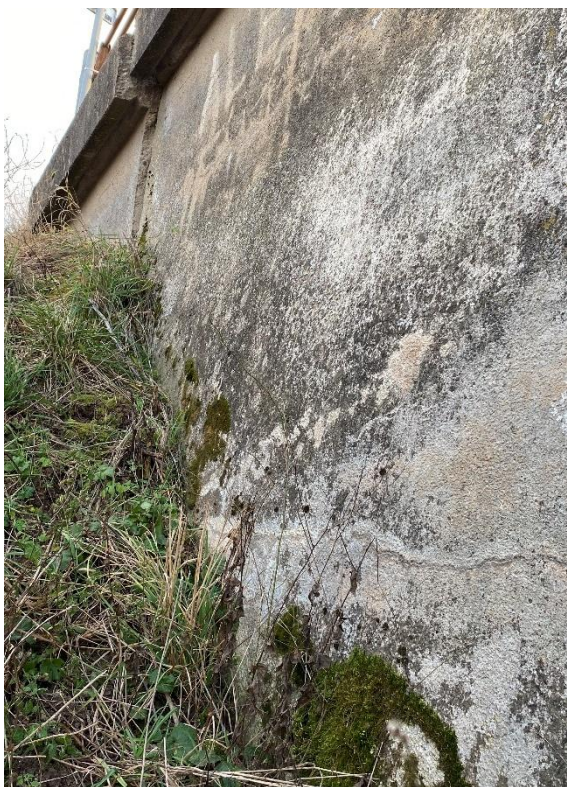
Obrázek 105: Detail trhlin vrchní části levého křídla OP2
