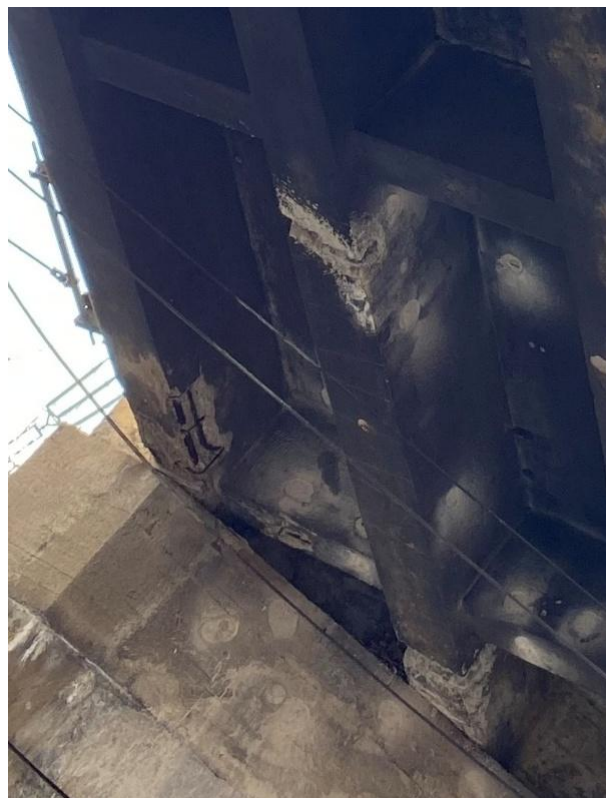
Obrázek 41: Nedostatečné zapravení sond
