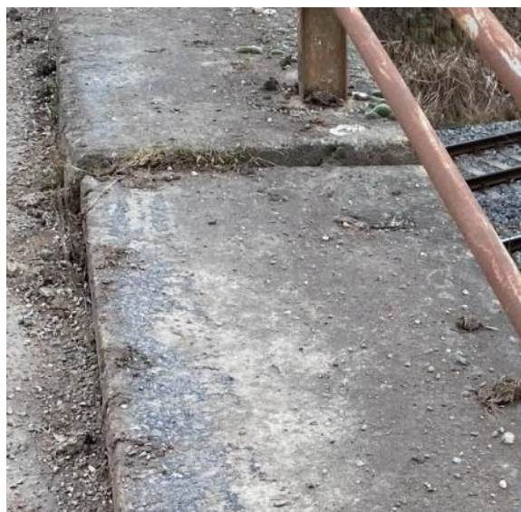
Obrázek 147: Spára pravé římsy po odstranění vegetace
