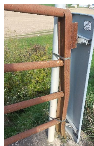
Obrázek 171: Zdeformovaný krajní sloupek levého zábradlí
