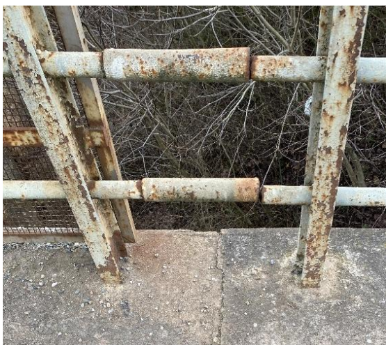
Obrázek 176: Nedoléhající dilatace pravého zábradlí
