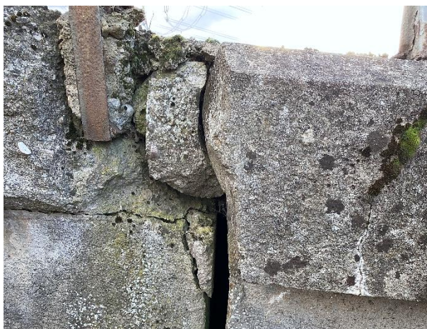
Obrázek 127: Degradace levé římsy – boční pohled
