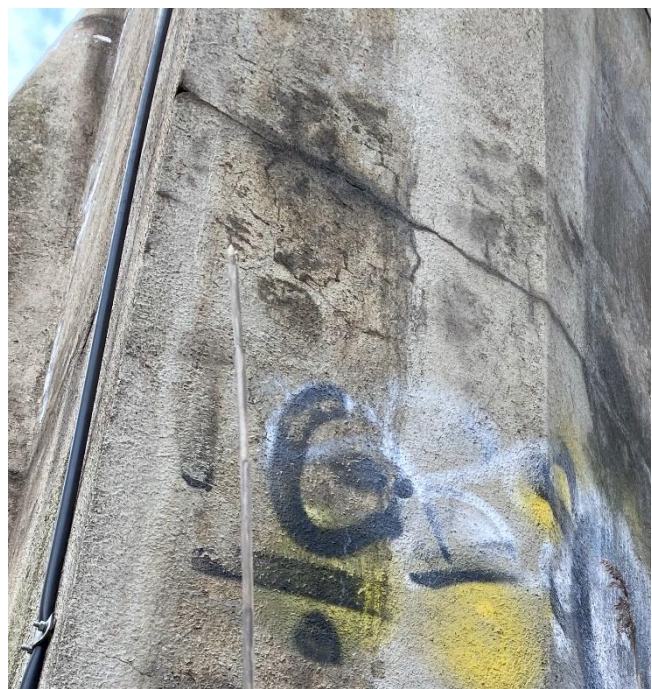
Obrázek 117: Trhlina v levé části dřívku při pohledu na OP1
