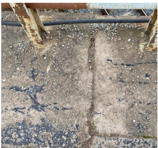
Obrázek 153: Trhlina se začínajícím rozpadem pravé římsy
