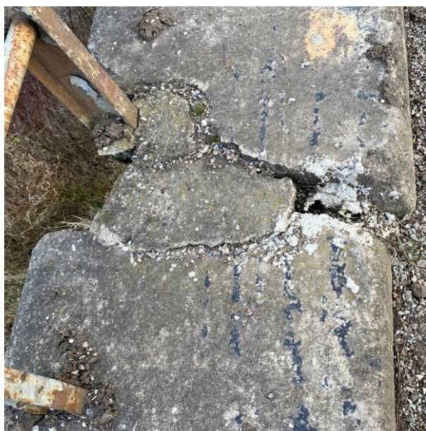
Obrázek 131: Degradace levé římsy po odstranění vegetace
