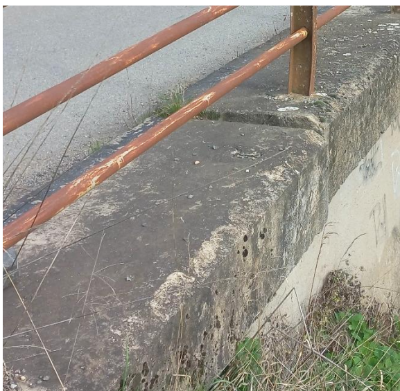
Obrázek 146: Spára pravé římsy, patrný výškový rozdíl
