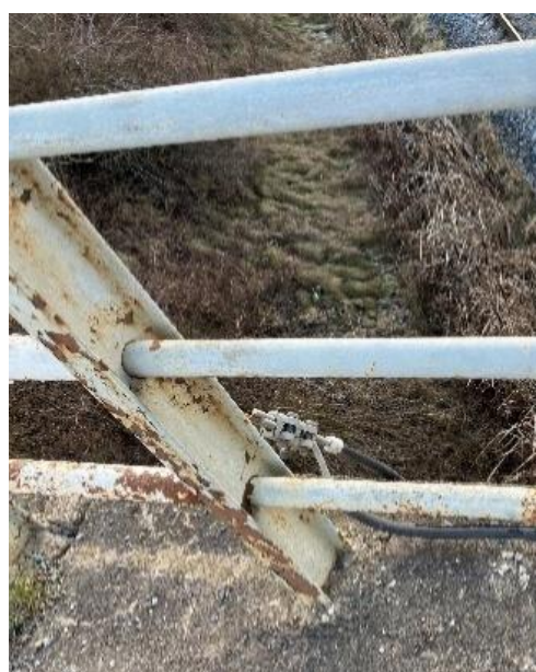
Obrázek 181: Ukolejnění pravého zábradlí
