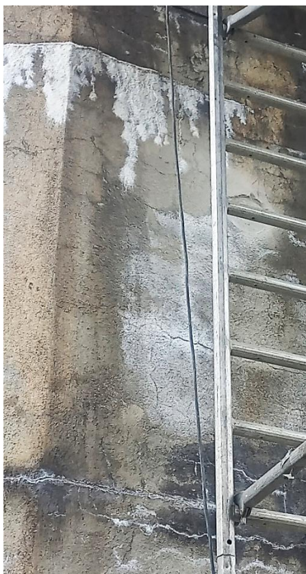
Obrázek 103: Detail trhlin a inkrustací
