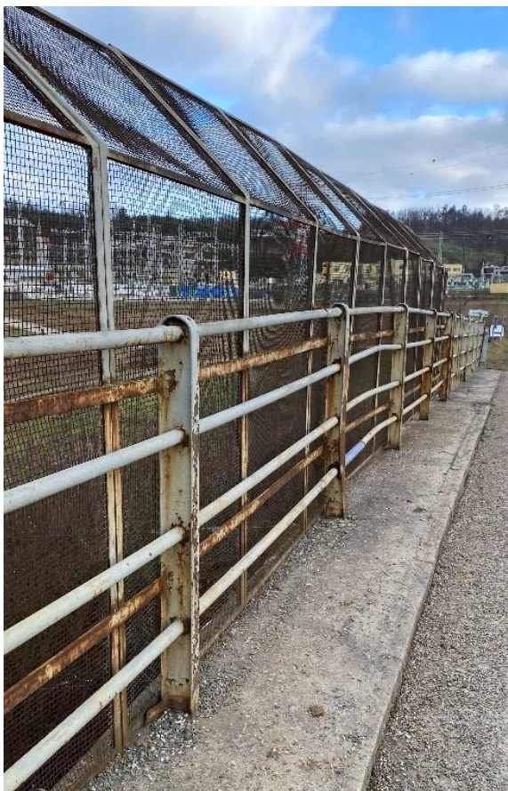
Obrázek 166: Pohled na protidotykovou zábranu na levé straně mostu ve směru staničení
