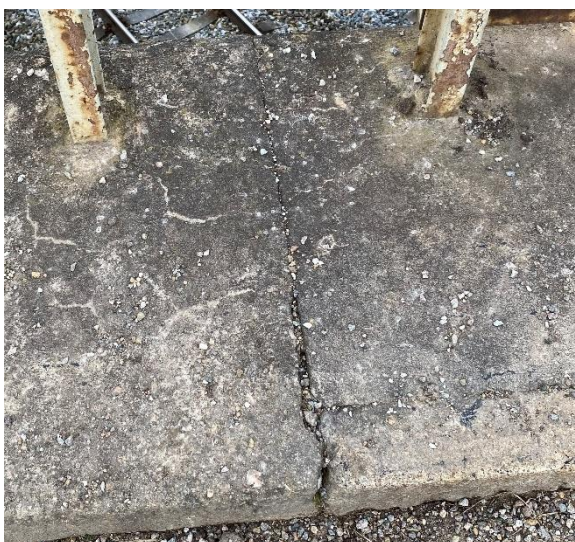
Obrázek 134: Trhliny v levé římse
