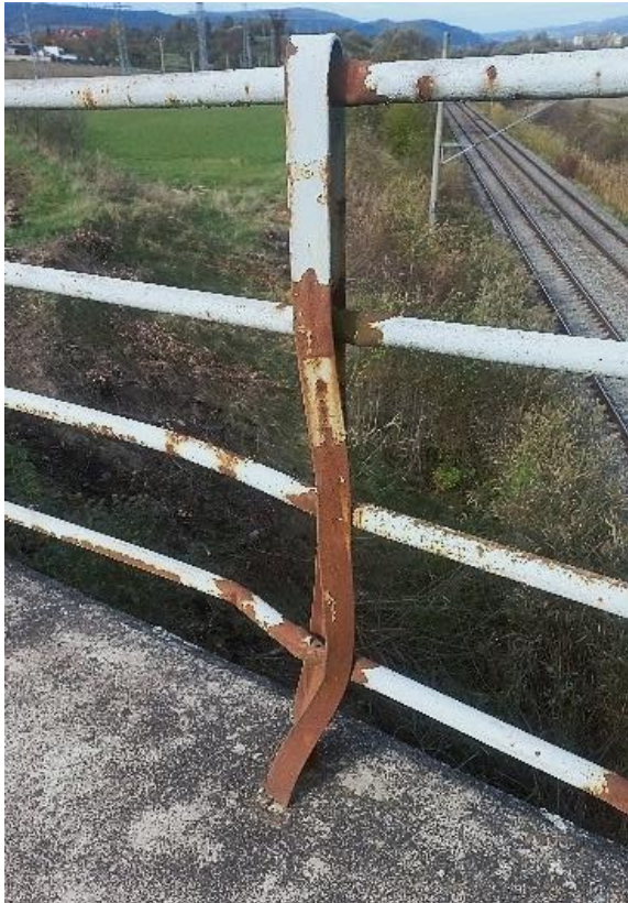
Obrázek 163: Zdeformovaný sloupek levého zábradlí
