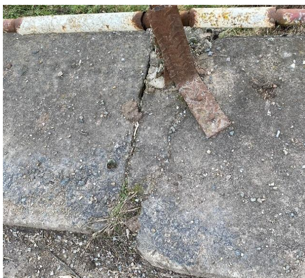
Obrázek 157: Trhliny v pravé římsě u znovu kotveného sloupku zábradlí
