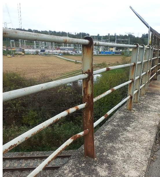
Obrázek 162: Promáčklá část levého zábradlí
