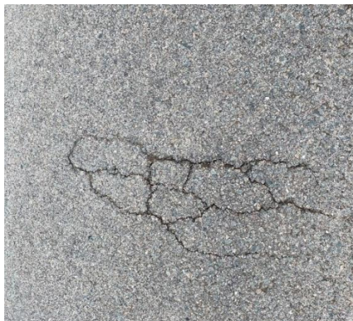
Obrázek 23: Začínající síťová trhлина krytu
