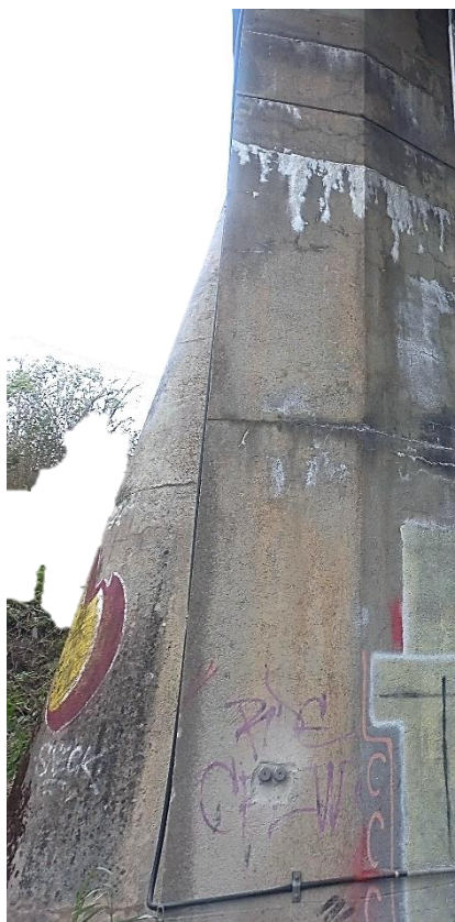
Obrázek 102: Detail inkrustace a trhlin na levé části dříku OP2
