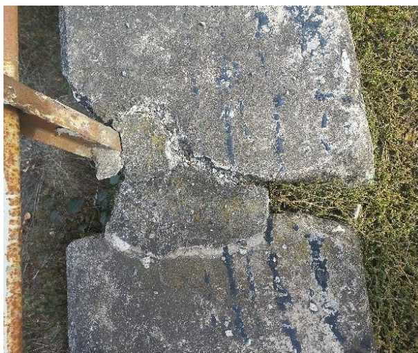
Obrázek 128: Degradace levé římsy – pohled shora
