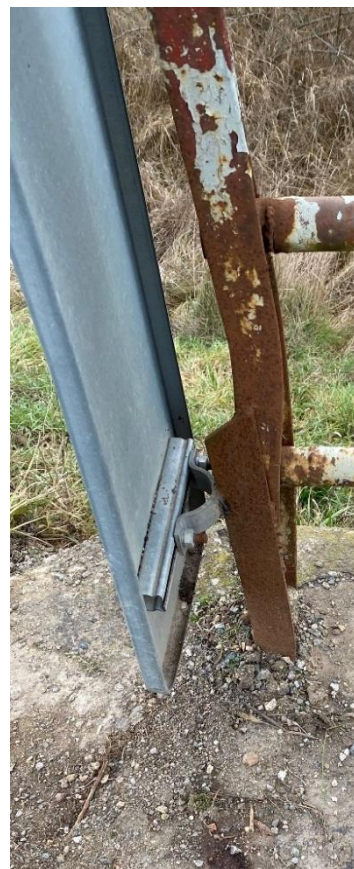
Obrázek 186: Deformace a kotvení koncového sloupku
