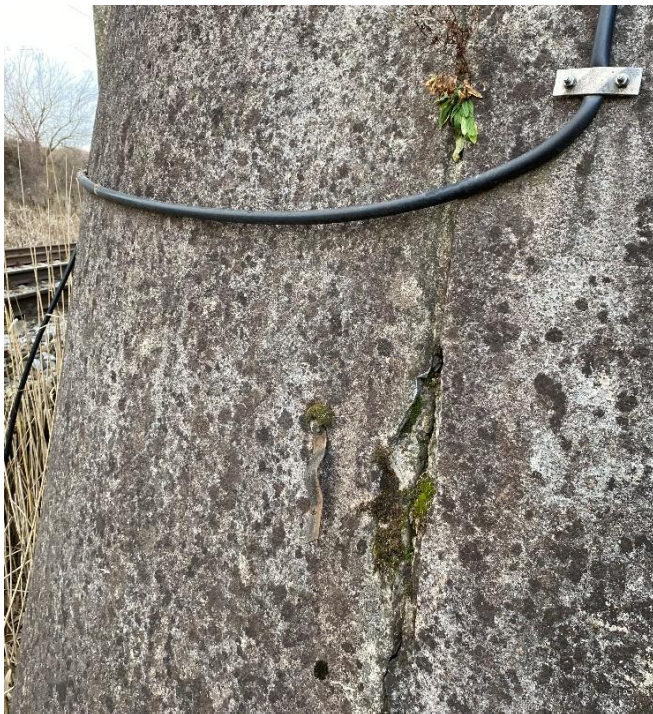
Obrázek 120: Spára levého křídla OP1 s patrným rozpadem nejen vlivem vegetace
