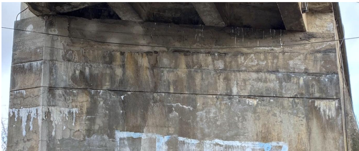
Obrázek 101: Stav úložného prahu OP2 – známky zatékání a inkrustace
