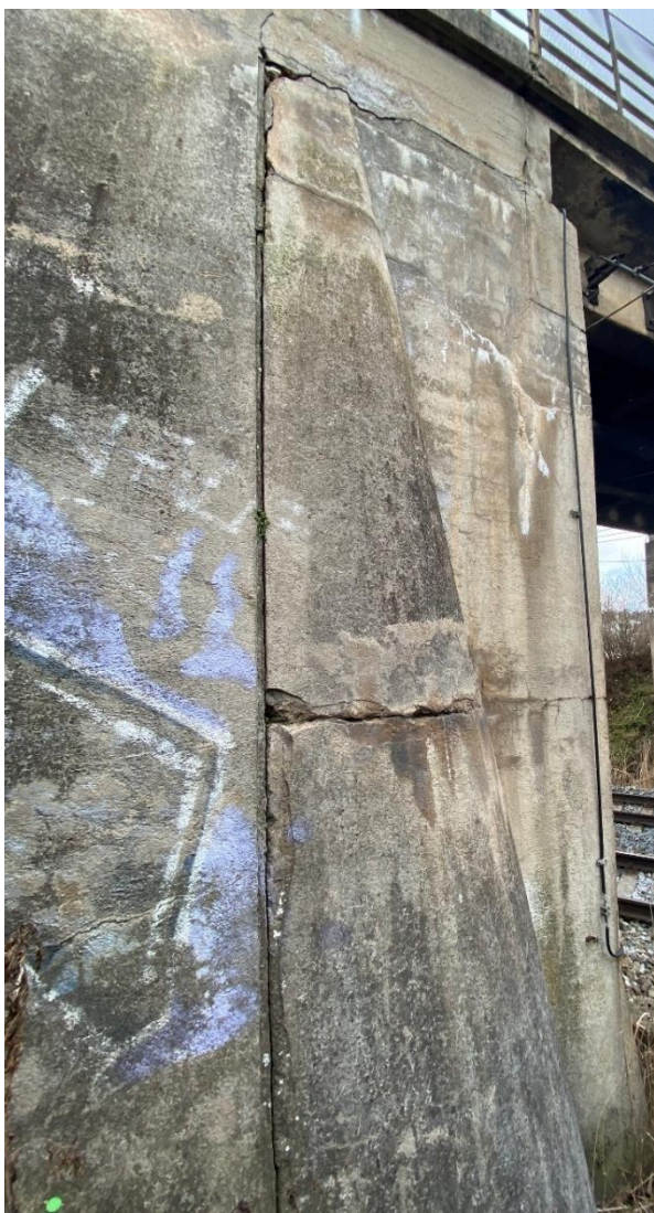
Obrázek 17: Poruchy pravého křídla OP1 – vydrolené pracovní spáry a viditelné stopy po zatékání
