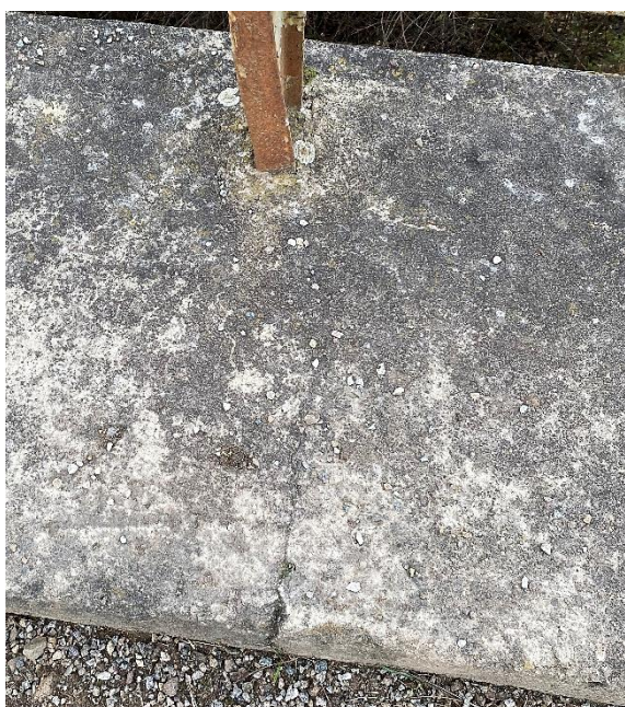
Obrázek 140: Trhlina v počáteční fázi na levé římsě
