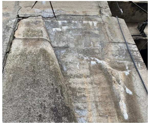
Obrázek 114: Detail poruch ve vrchní části
