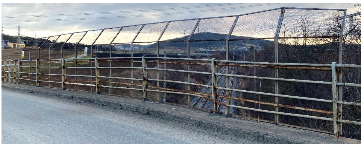
Obrázek 173: Deformace pravého zábradlí a protidotykové zábrany
