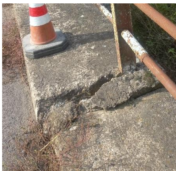
Obrázek 25: Degradace betonu pravé římsy – trhliny a patrný pozůstatek vegetace
