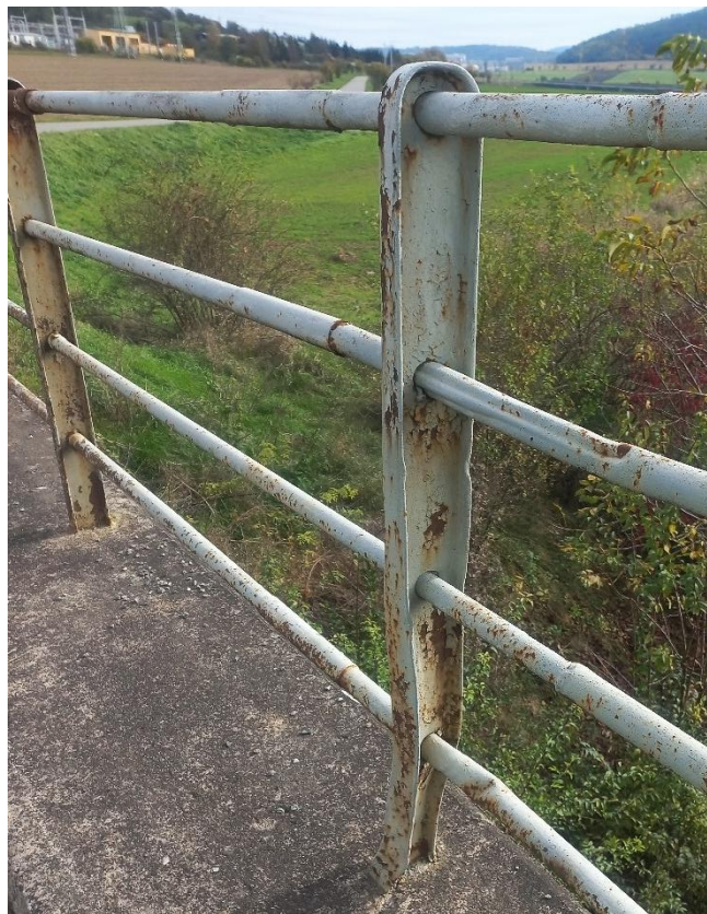
Obrázek 183: Deformace sloupku pravého zábradlí
