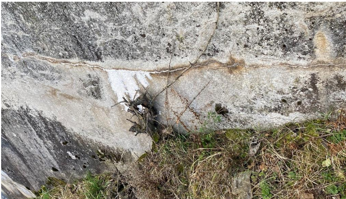
Obrázek 123: Trhlina s inkrustací v horní části levého křídla DP1
