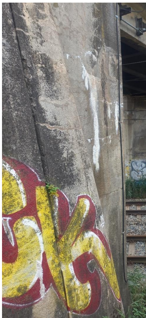
Obrázek 18: Poruchy levého křídla OP2 – vegetace v pracovní spáře a inkrustrace
