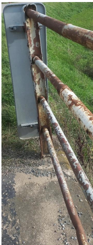
Obrázek 185: Prohnutý koncový sloupek pravého zábradlí ve směru na Drásov
