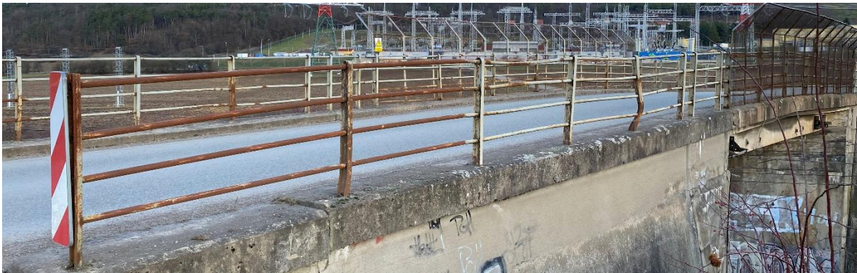
Obrázek 16: Celkový pohled na mostní zábradlí v jeho aktuálním stavu
