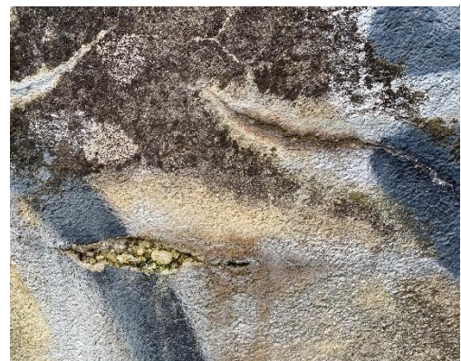
Obrázek 121: Degradace povrchu levého křídla OP1 ve spodní části
