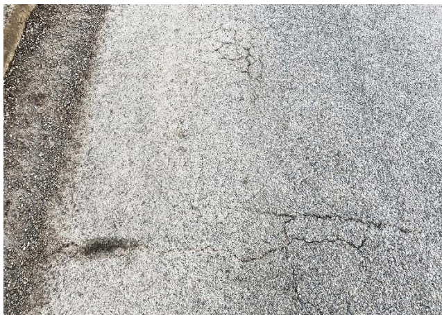
Obrázek 22: Detail trhlinek v živičném krytu
