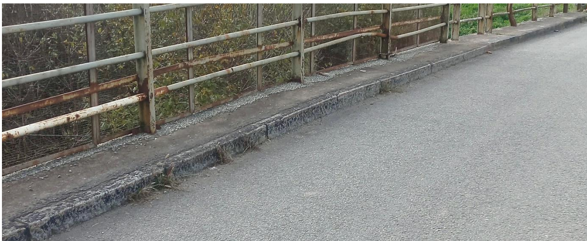
Obrázek 145: Pohled na pravou mostní římsu s vegetací (v menším rozsahu než u levé římsy)
