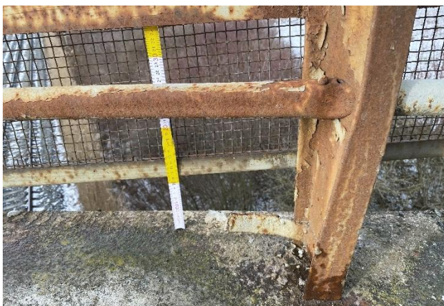
Obrázek 26: Nevhodná mezera mezi římsou a protidotykovou zábranou
