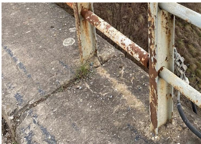
Obrázek 154: Trhlina pravé římsy – mírný rozpad a vegetace
