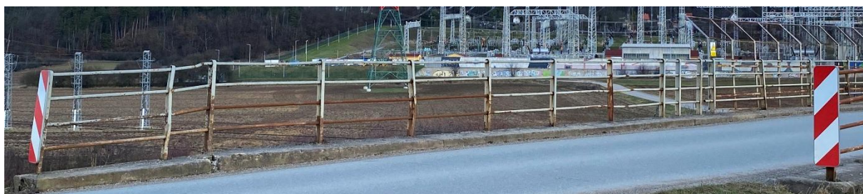
Obrázek 160: Pohled na zkorodované a pokroucené zábradlí na levé straně mostu
