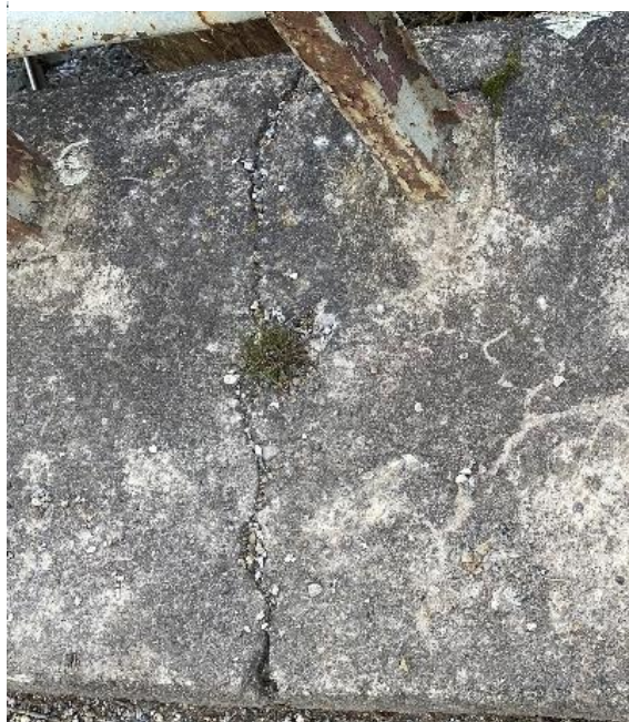
Obrázek 139: Trhlina levé římsy s vegetací
