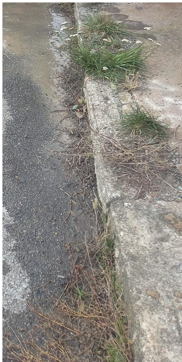
Obrázek 136: Vegetace a degradace betonu levé římsy
