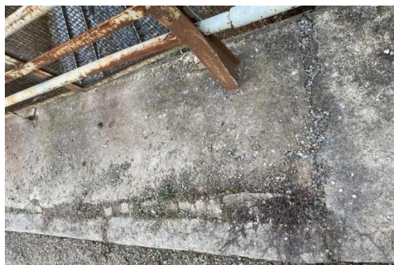
Obrázek 138: Trhliny po odstranění vegetace na levé římsě
