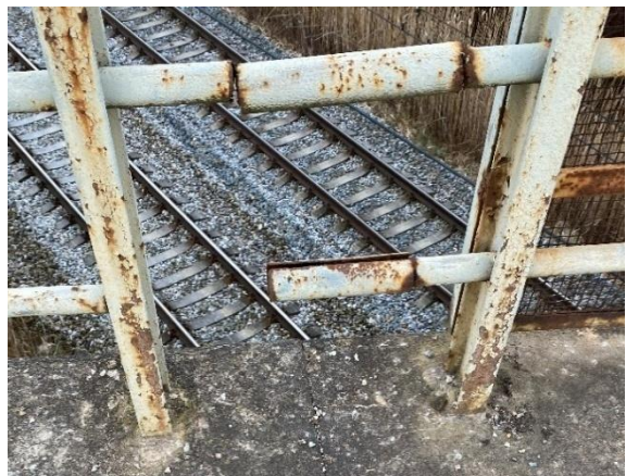
Obrázek 165: Chybějící část výplně levého zábradlí
