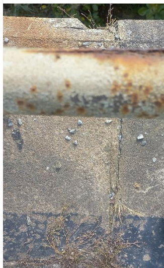
Obrázek 151: Trhlina pravé římsy s odumírající vegetací
