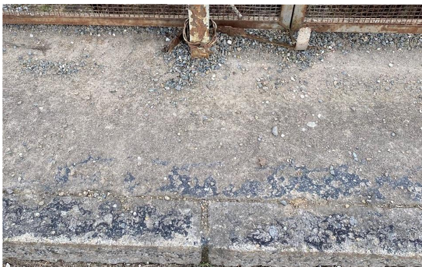
Obrázek 152: Spáry obrubníků pravé římsy
