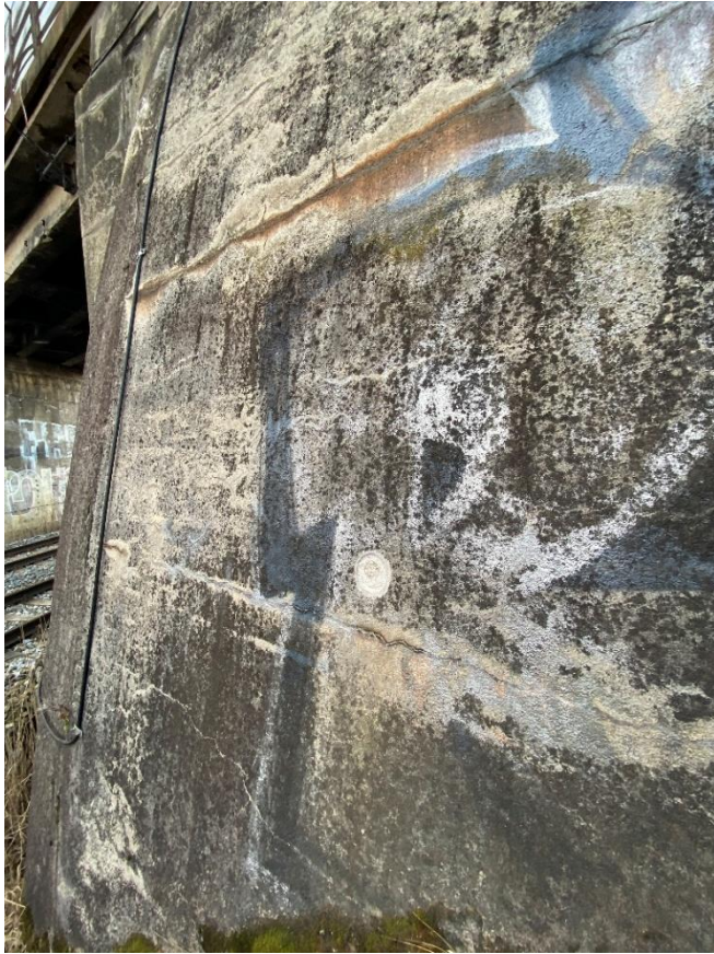
Obrázek 118: Trhliny levého křídla OP1
