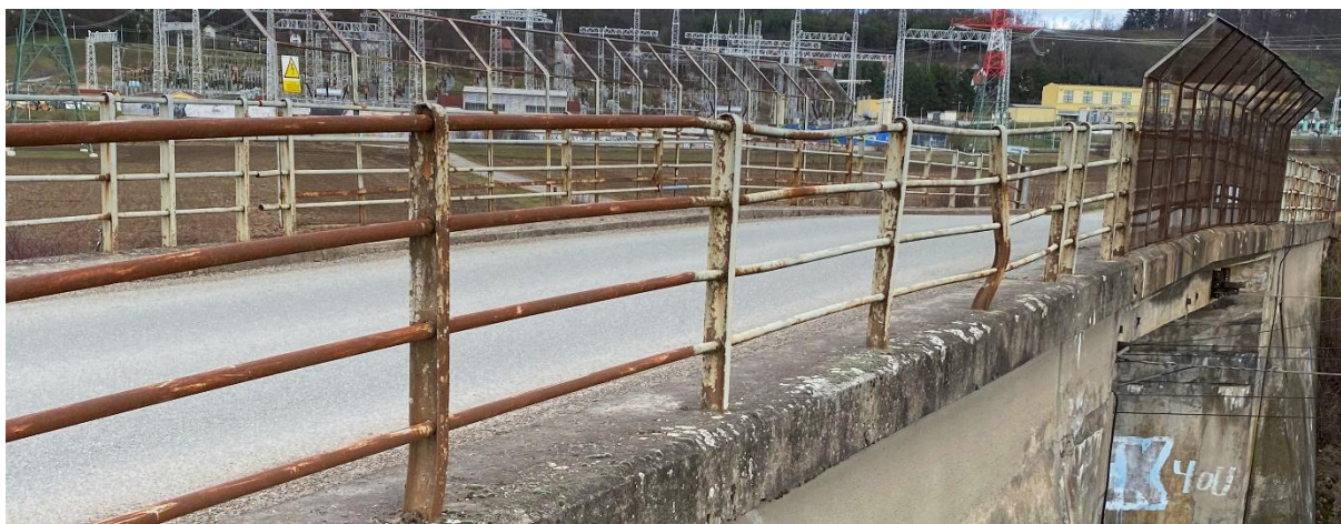
Obrázek 172: Širší pohled na deformované pravé zábradlí
