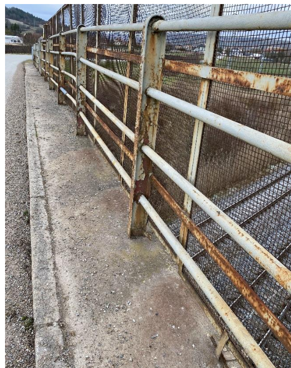
Obrázek 167: Pohled proti směru staničení na zkorodované části vybavení na levé straně mostu
