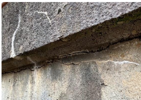
Obrázek 129: Trhlínky levé římsy v hraně s levým křídlem OP1
