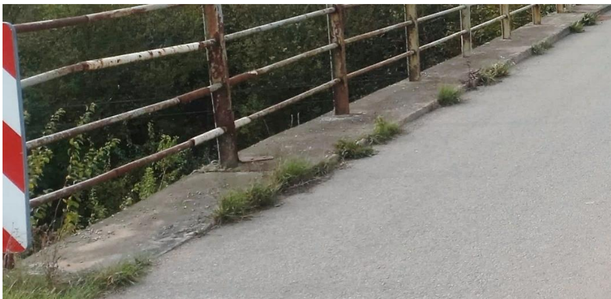
Obrázek 155: Pravá římsa při pohledu proti směru staničení s patrnou vegetací
