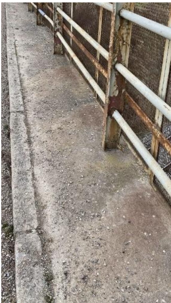
Obrázek 137: Spáry obrubníků u levé římsy
