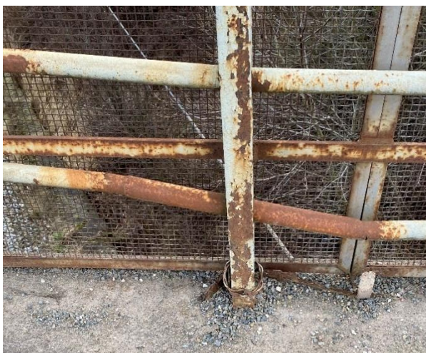
Obrázek 177: Zdeformovaná výplň pravého zábradlí
