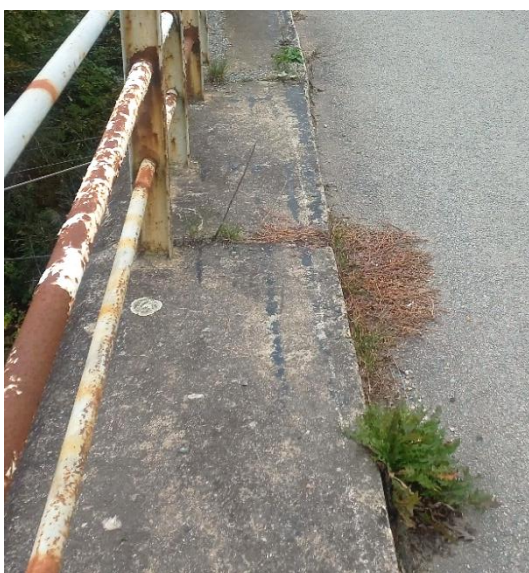
Obrázek 156: Vegetace prorůstající trhlinami v pravé římsě
