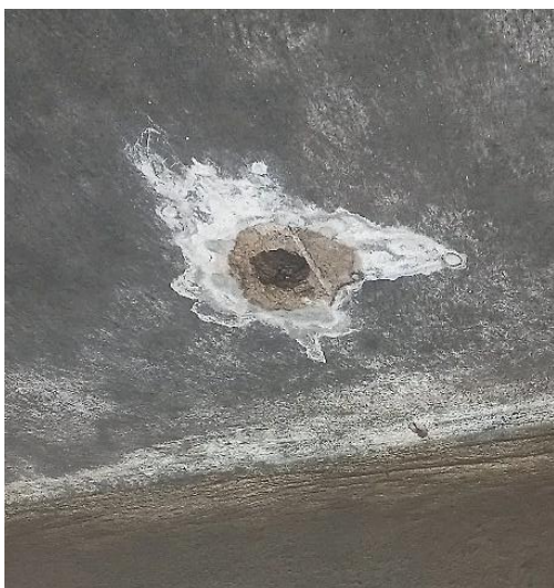
Obrázek 55: Průvrt ze spodního líce konstrukce
