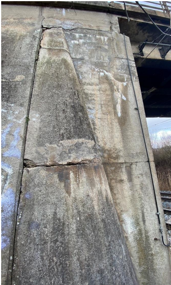
Obrázek 113: Pracovní spáry pravého křídla OP1 ve špatném stavu
