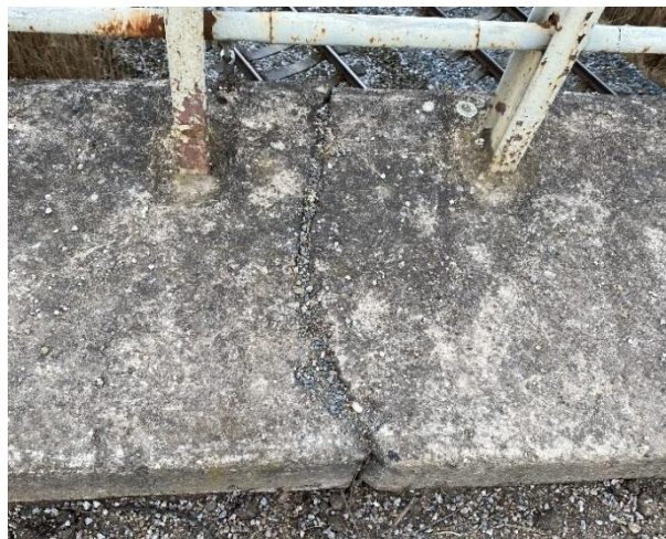
Obrázek 133: Trhlina v levé římse
