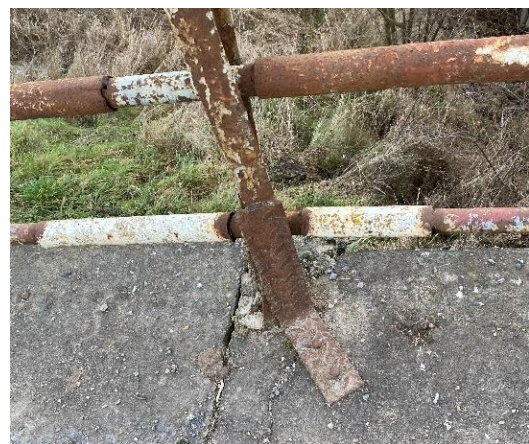
Obrázek 27: Opakovaně opravované uchycení sloupku zábradlí
