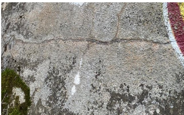
Obrázek 107: Trhlina levého křídla
