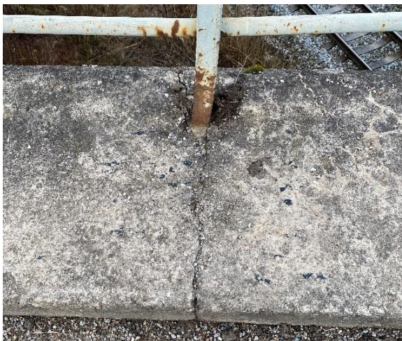
Obrázek 132: Trhlina levé římsy v místě kotvení sloupku zábradlí
