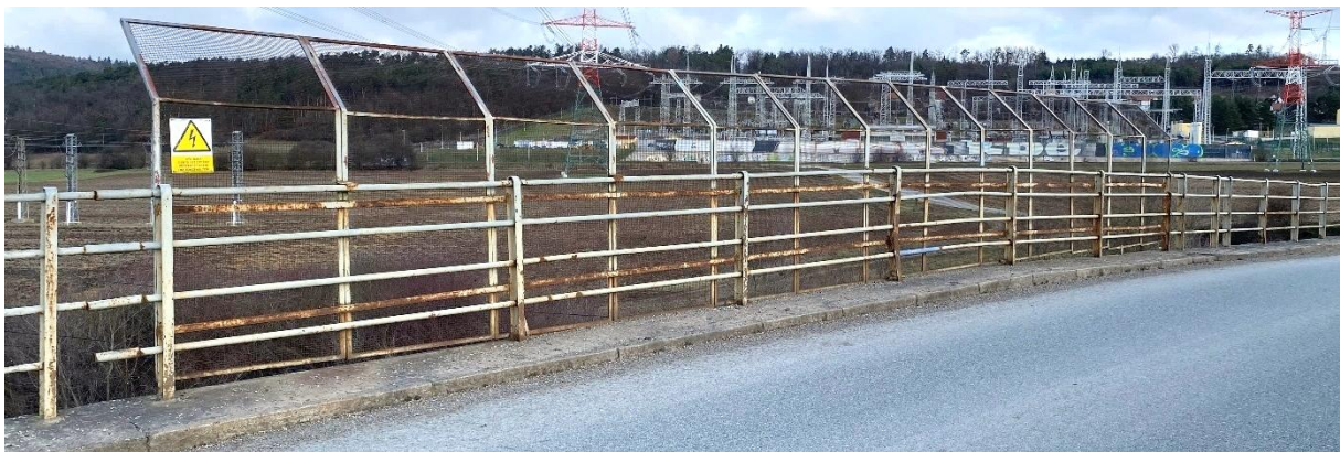
Obrázek 15: Fotodokumentace stavu mostního vybavení na levé straně
