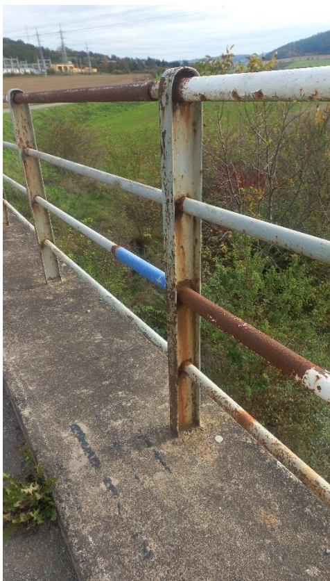
Obrázek 182: Pravé zábradlí – koroze, oprava
