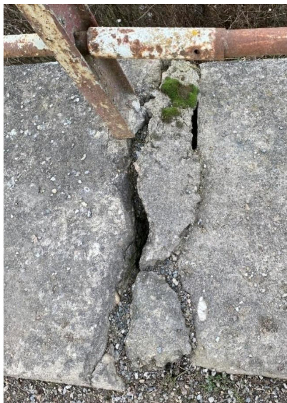
Obrázek 143: Rozpad betonu levé římsy u přechodové oblasti ve směru na Drásov
