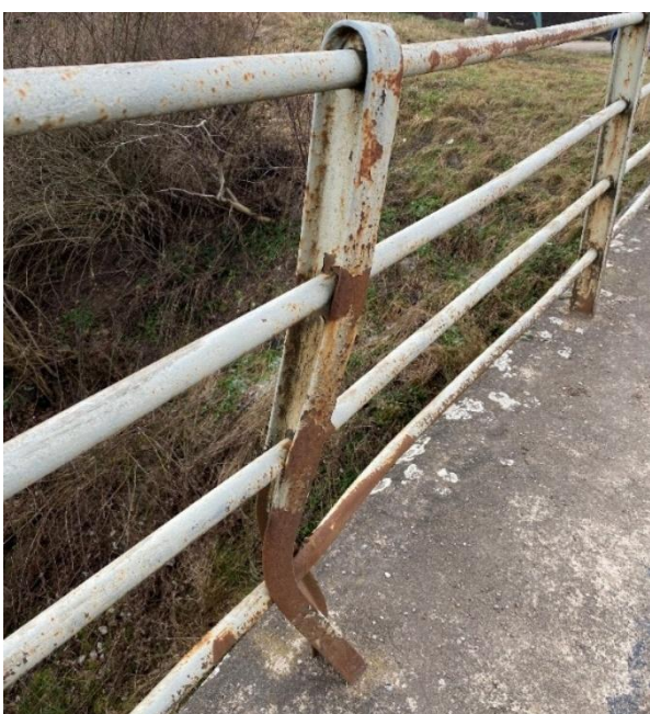
Obrázek 174: Pokroucený sloupek pravého zábradlí
