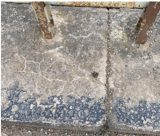
Obrázek 149: Trhlina pravé římsy
