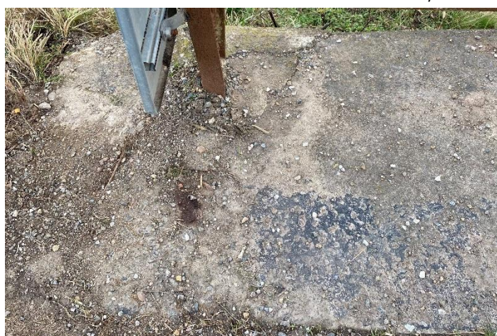
Obrázek 158: Konec pravé římsy ve směru na Drásov – trhlinky v oblasti kotvení sloupku
