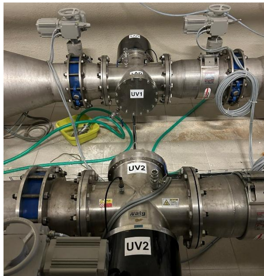
Obr. 3.10 UV lampy na úpravě vody Znojmo [autor]
