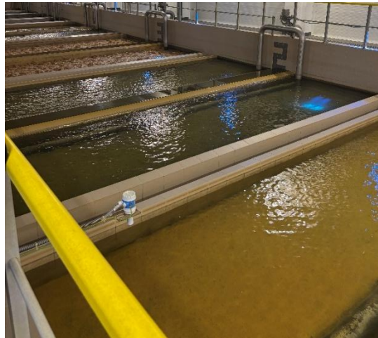
Obr. 2.15 Otevřené rychlofiltry na úpravě vody Znojmo [autor]
