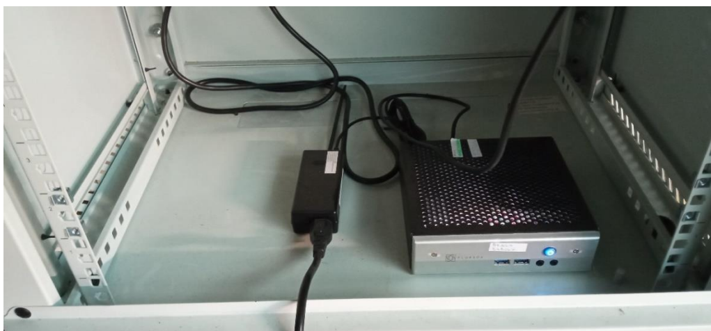
Obrázek 18: Zapojení serveru v rozvaděči
