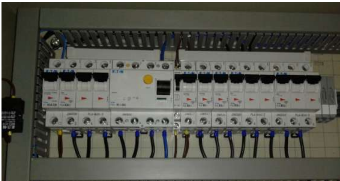
Obrázek 12 Ochranné přístroje (proudový chránič, jističe) osazeny v rozvaděči
