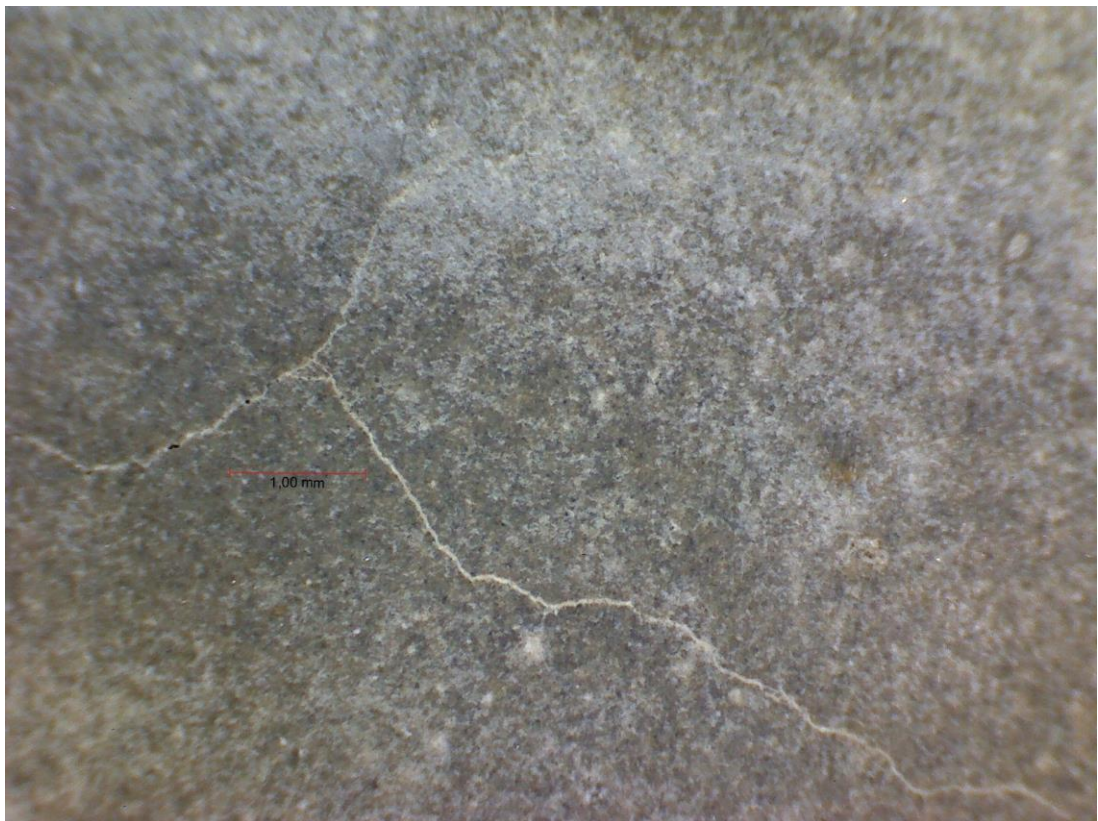
Obr. 47: Detail vyplněné mikrotrhliny pod mikroskopem
