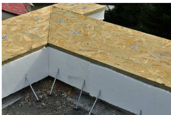
Obr. 47 - rozšíření a zateplení atiky
