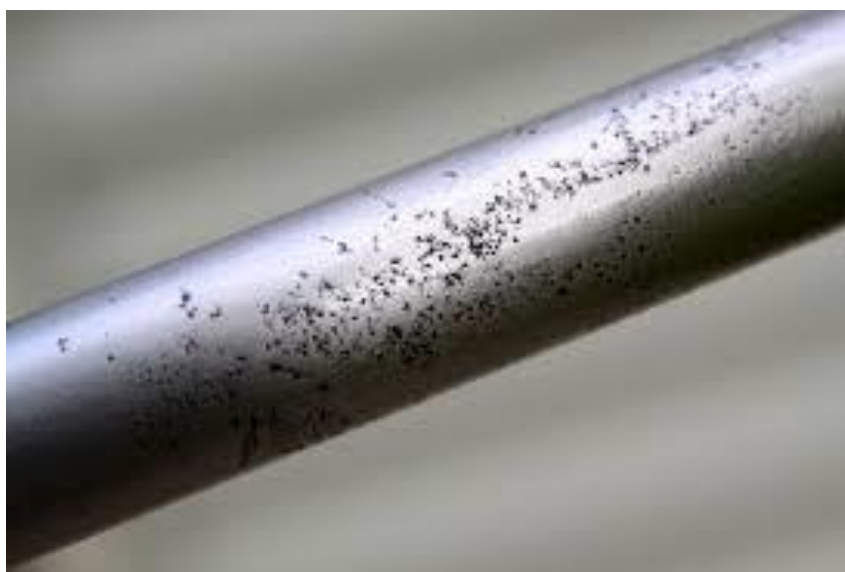
Obr. 9 Ukázka koroze zvané pitting [12]
