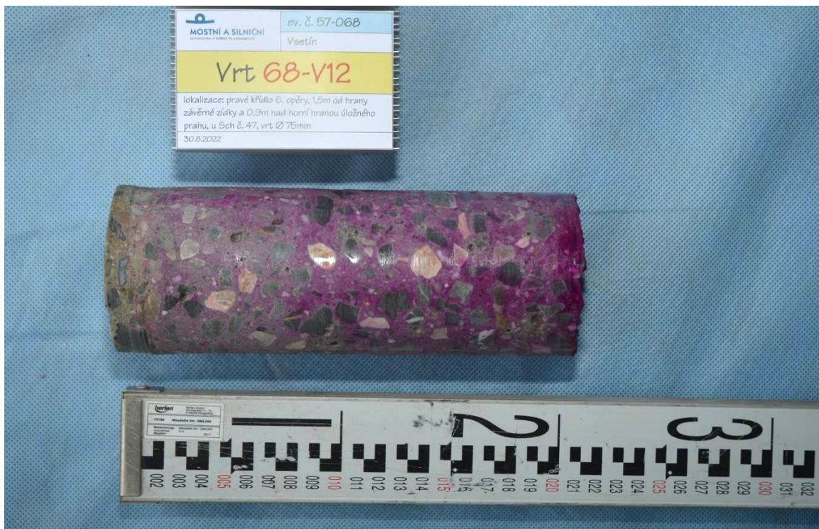
Obr. 3.64: Jádrový vývrt z pravého křídla 6. opěry [25]
