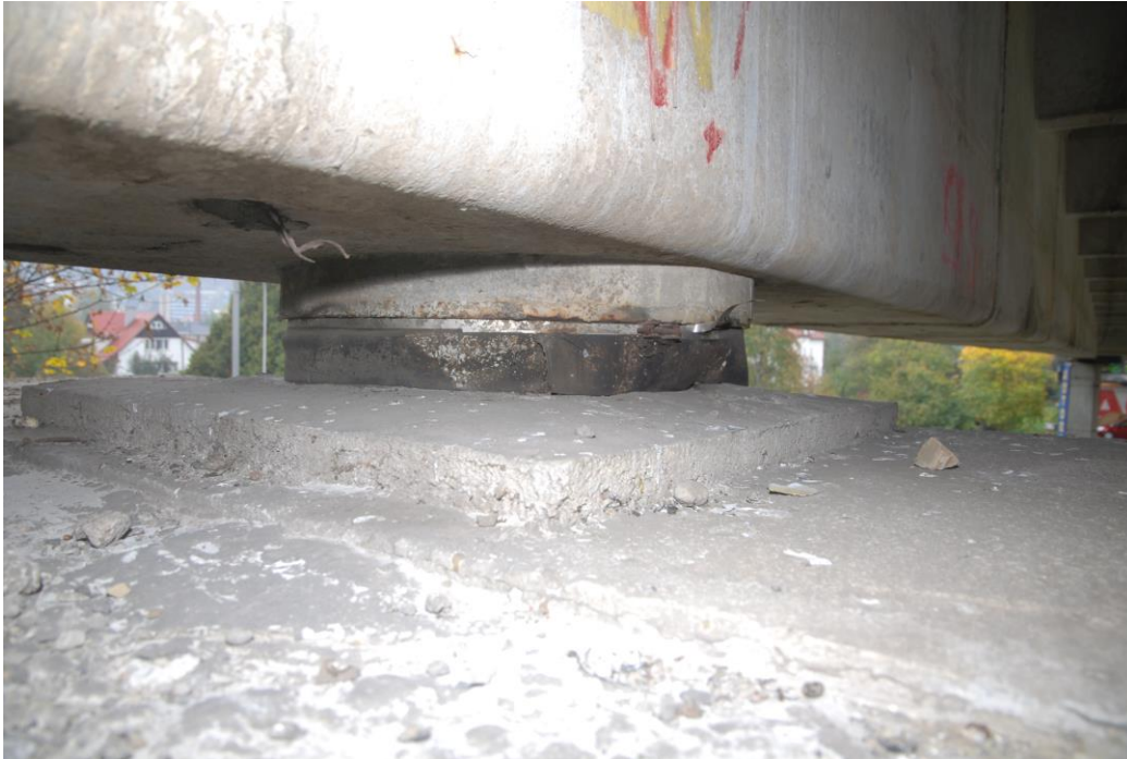
Obr. 3.23: Levé ložisko na O1 [25]
