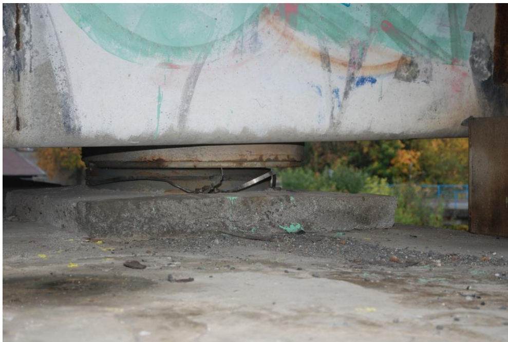
Obr. 3.25: Levé ložisko na O6 [25]
