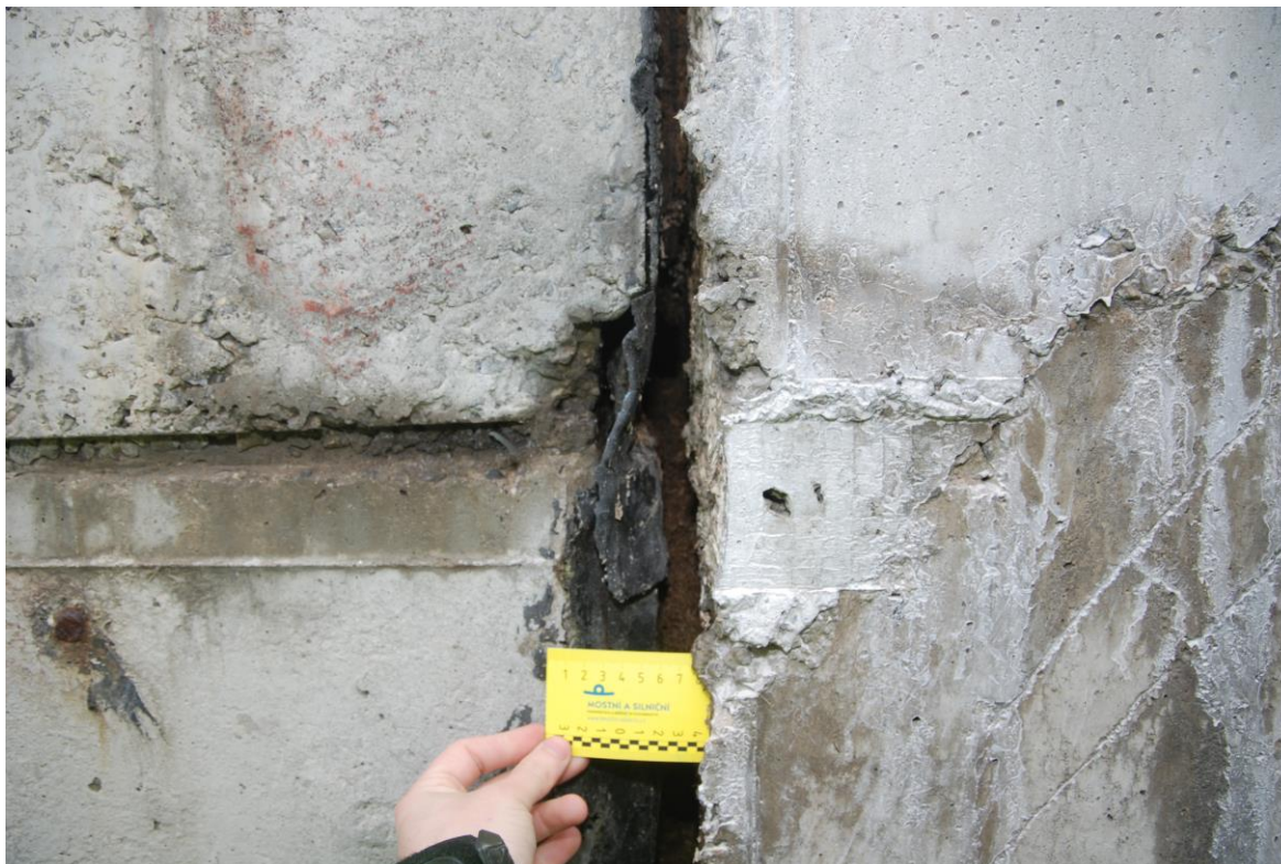
Obr. 3.13: Spára mezi opěrou O1 a křídlem [25]
