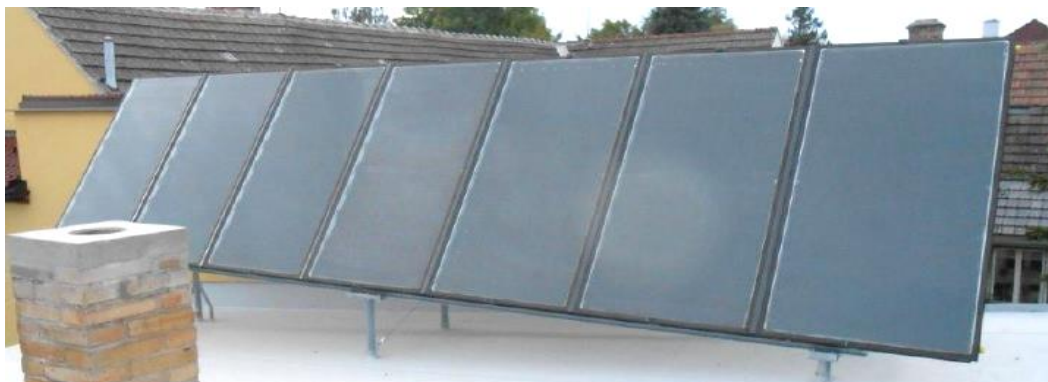
Obrázek 26: Pohled na nainstalované solární kolektory TS 400
